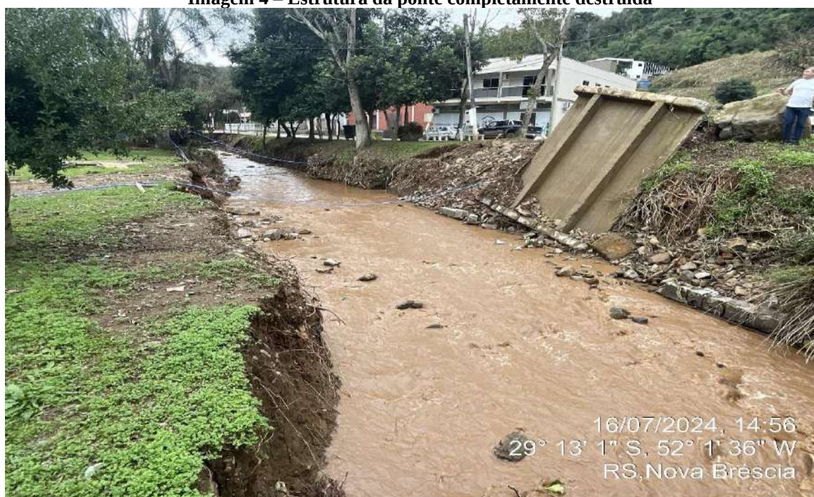
Imagem 4 – Estrutura da ponte completamente destruída
