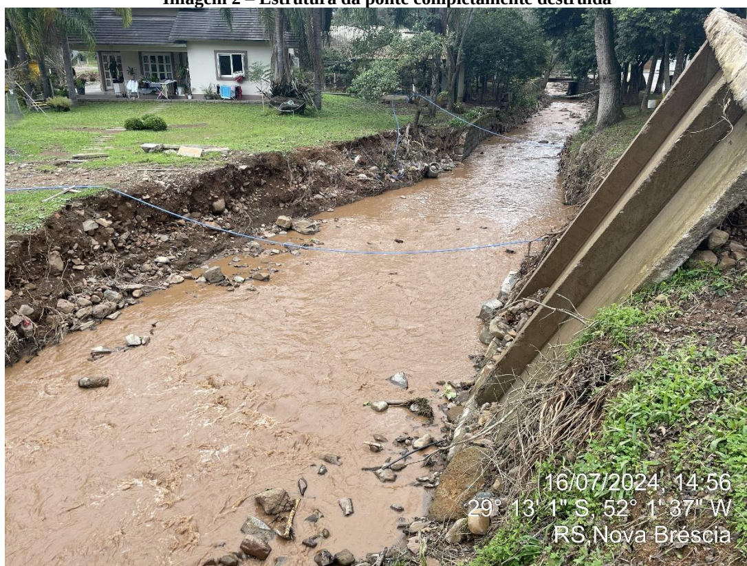
Imagem 2 – Estrutura da ponte completamente destruída
