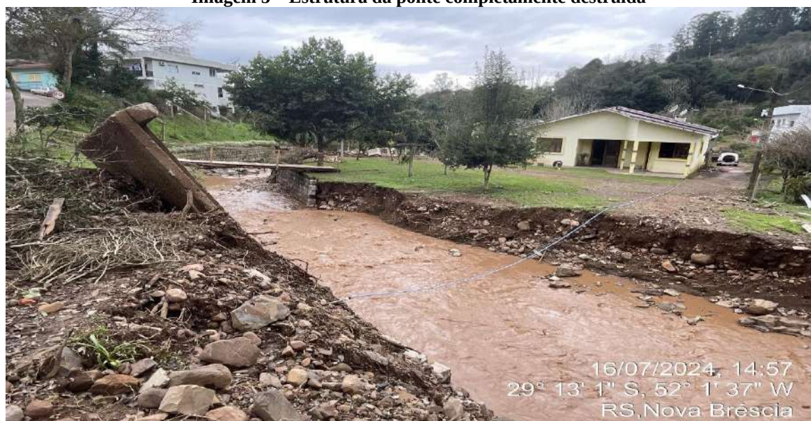
Imagem 5 – Estrutura da ponte completamente destruída
