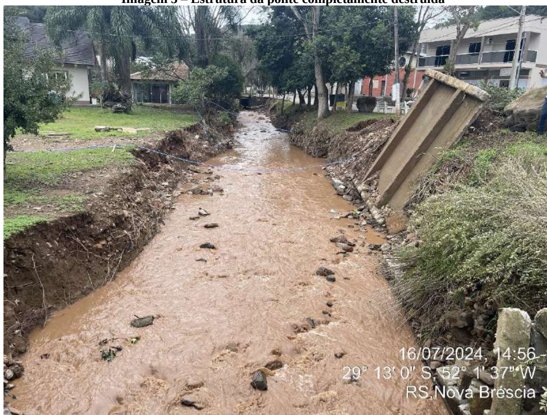
Imagem 3 – Estrutura da ponte completamente destruída
