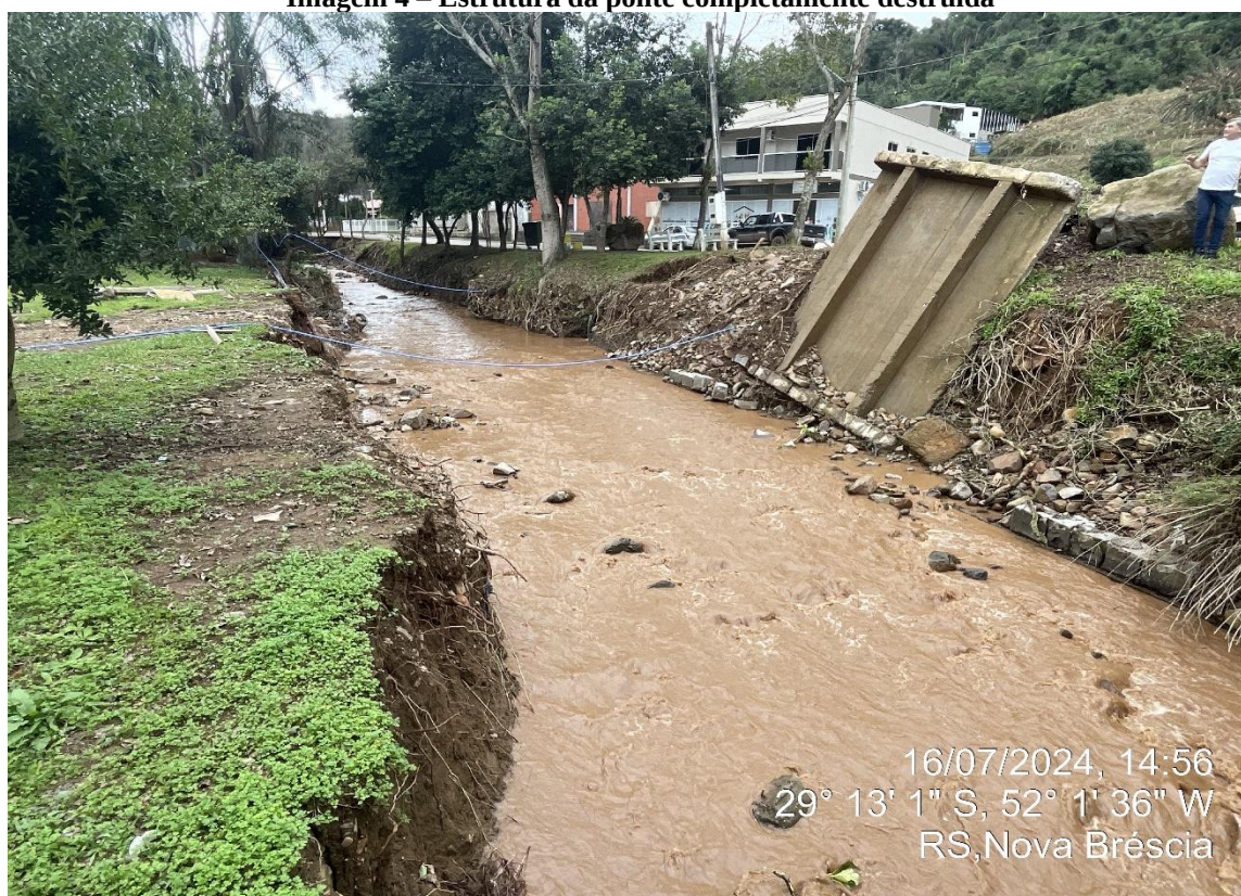
Imagem 4 – Estrutura da ponte completamente destruída
