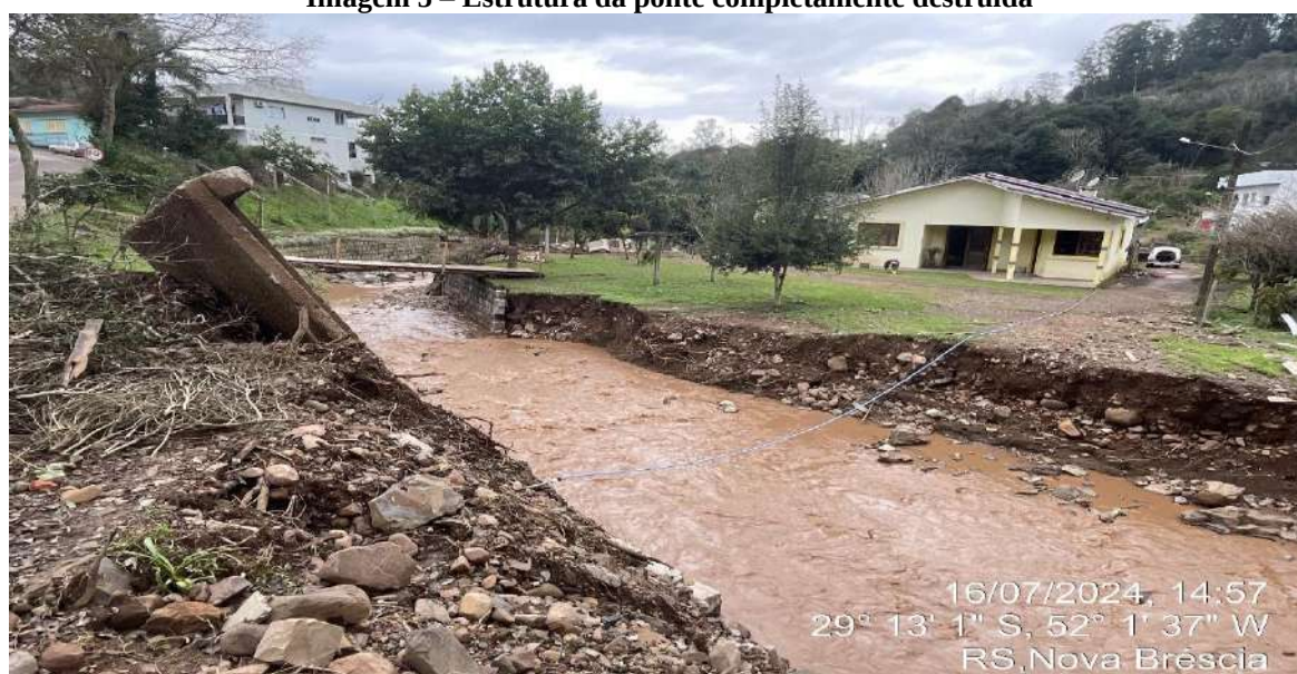
Imagem 5 – Estrutura da ponte completamente destruída
