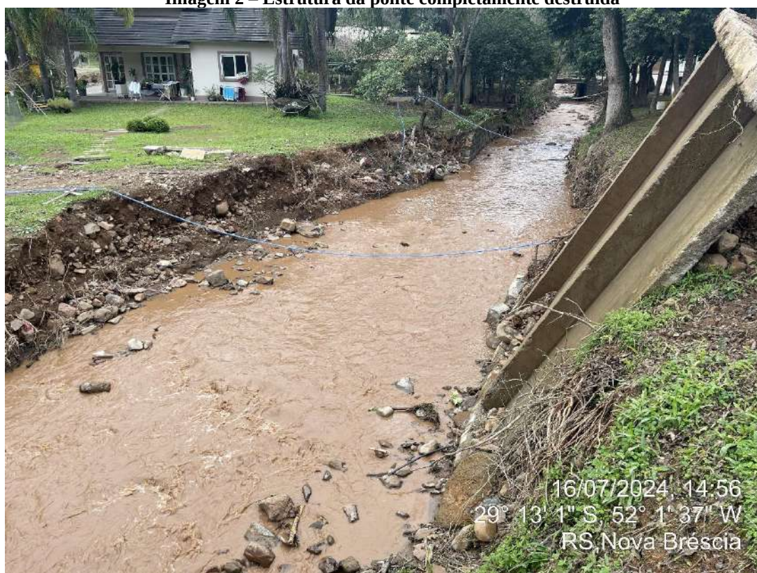
Imagem 2 – Estrutura da ponte completamente destruída
