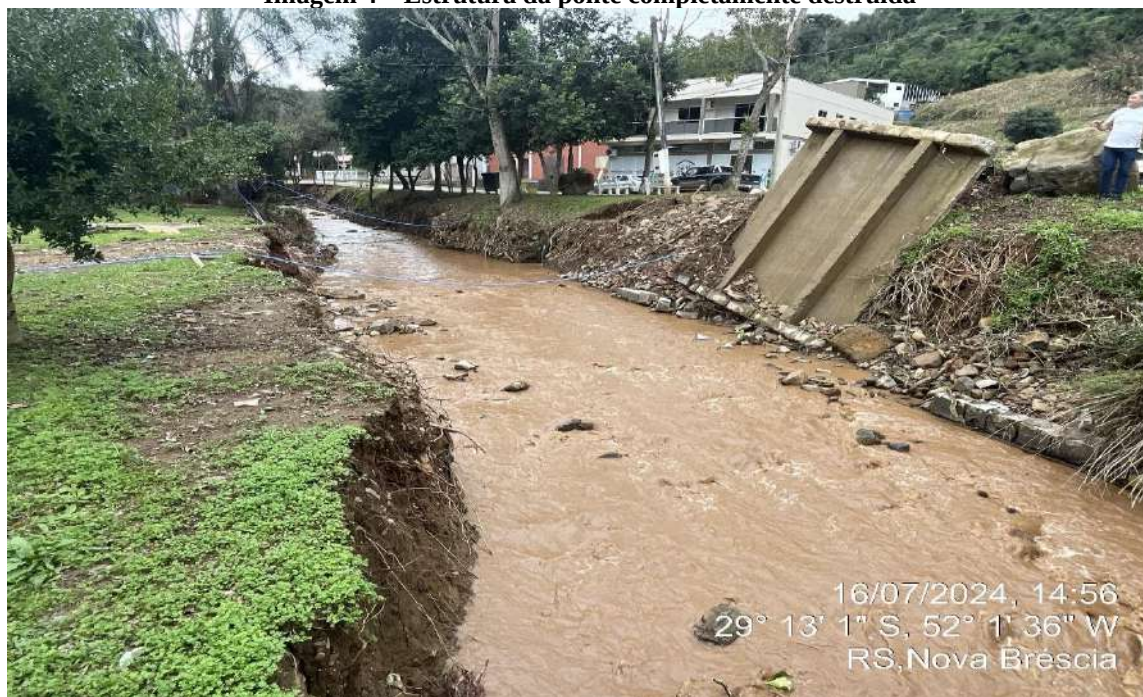
Imagem 4 – Estrutura da ponte completamente destruída
