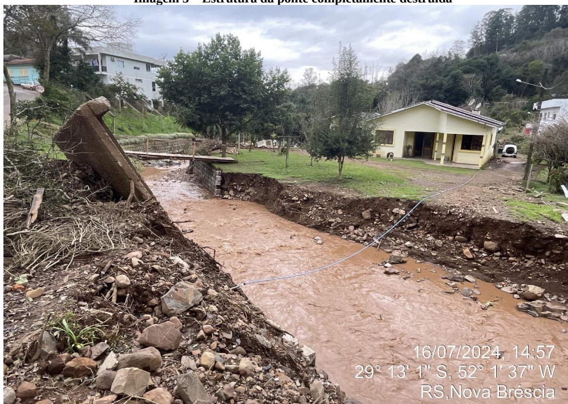
Imagem 5 – Estrutura da ponte completamente destruída
