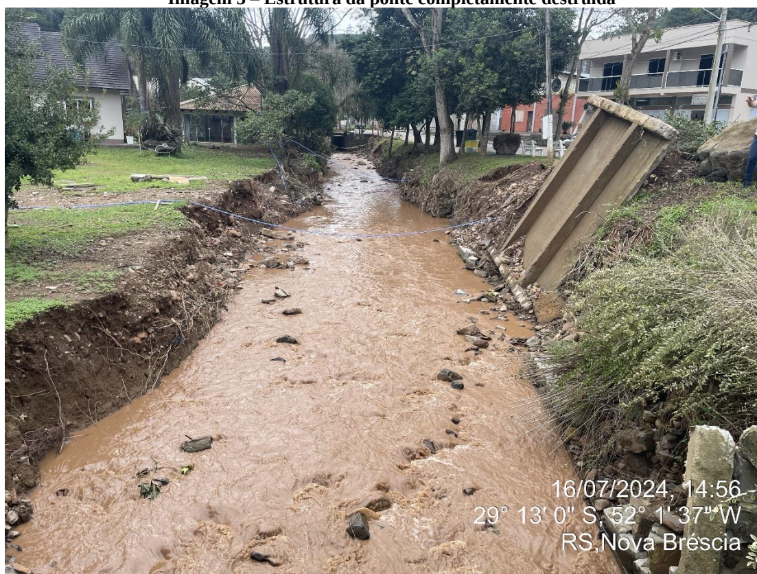
Imagem 3 – Estrutura da ponte completamente destruída
