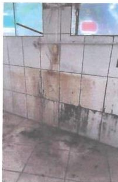
Foto 6 — Tomadas e condutas danificados.
