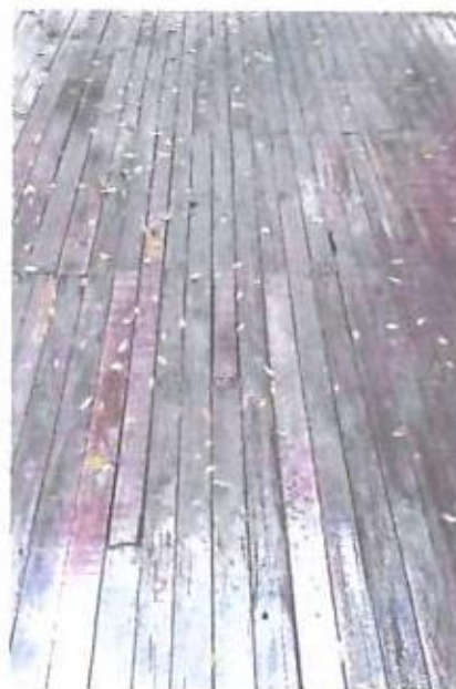
Foto 4 — Tábua em estado de deterioração.
