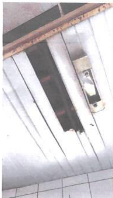
Foto 1 — Detalhe da abertura no forro, com ripamento e telha cerâmica visíveis.
