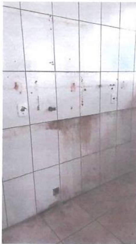
Foto 9 — Ambiente interno com manchas acentuadas no piso e azulejo.
