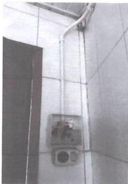
Foto 5 — Quadro de cargas com fiação exposta, sem tampa e condutores com bitola incompatível.
