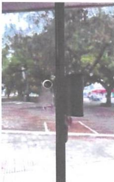
Foto 7 — Ausência de sistema de travamento em portas e janela.
