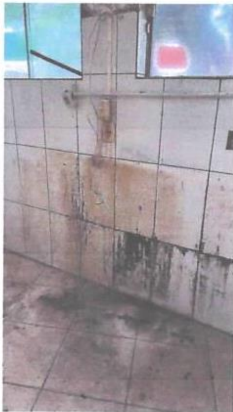
Foto 8 — Ambiente interno com manchas acentuadas no piso e azulejo.
