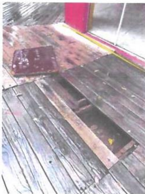
Foto 3 — Tábua do deck rompida, com estrutura de apoio exposta.
