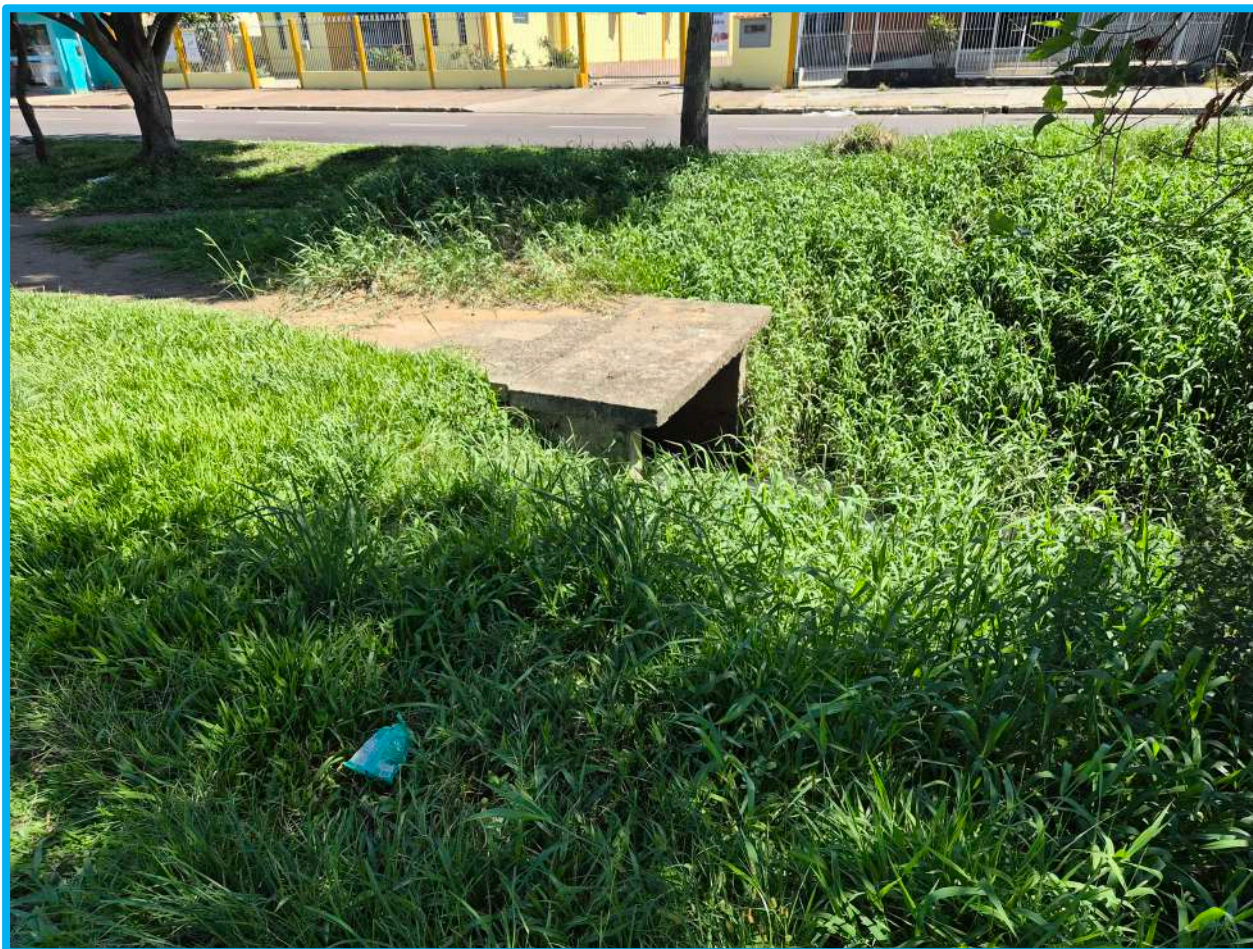
Figura 15 - Ala de saída da tubulação na Avenida Lupicínio Rodrigues
