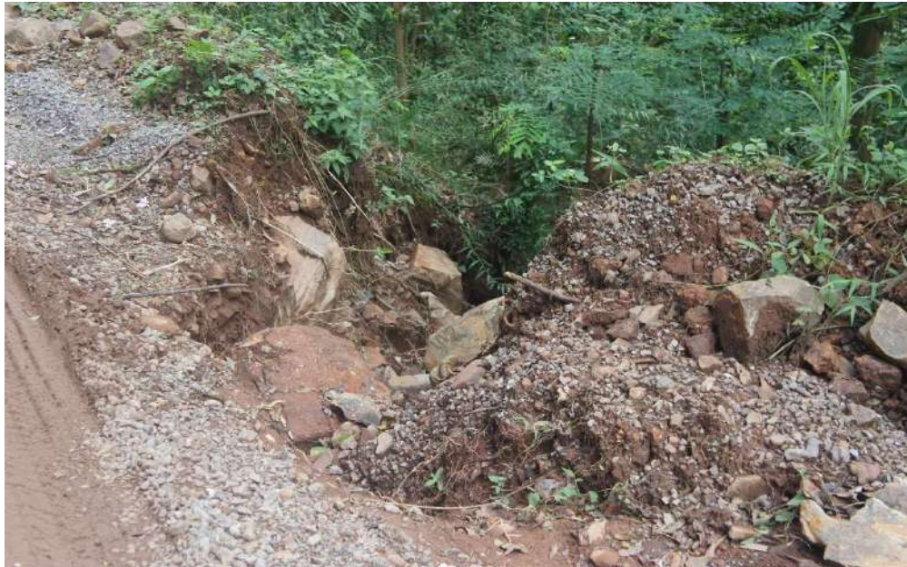
Figura 15: Erosão de bordo identificada na estaca km 4+860.
