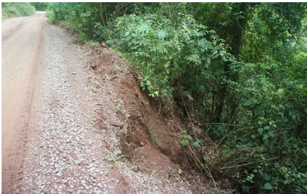
Figura 23: Erosão de bordo identificado na estaca km 6+710.
