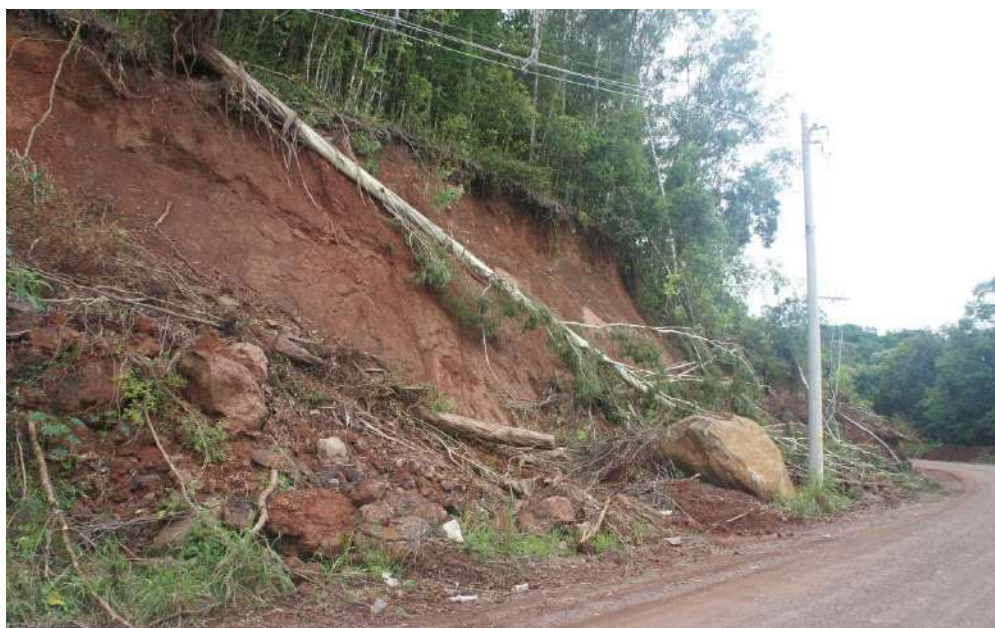
Figura 5: Escorregamento de talude na estaca km 1+920.
