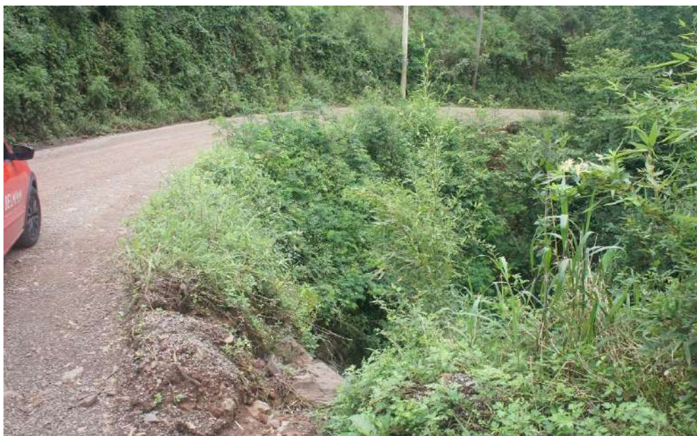
Figura 2: Erosão identificada na estaca km 0+500, próximo à contenção de pedras.
