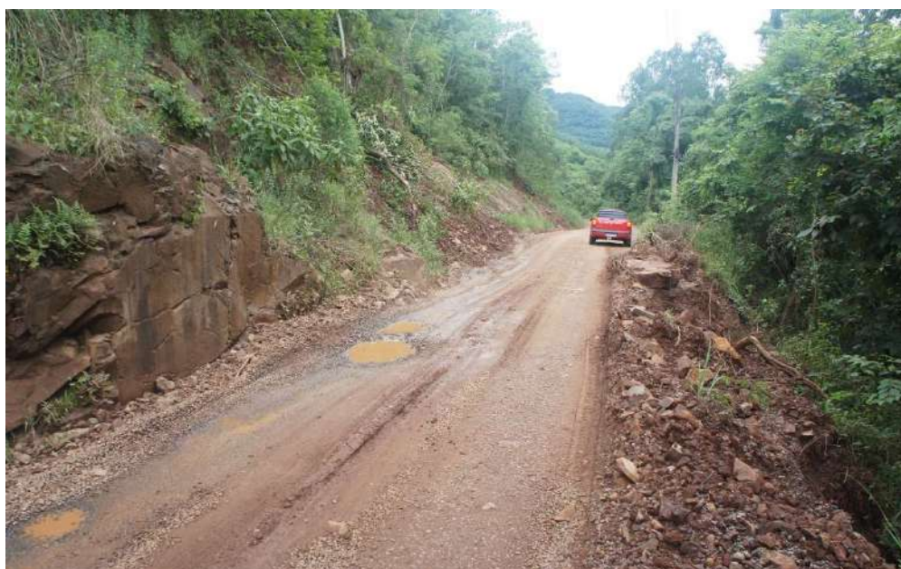
Figura 18: Ápice de desmoronamento na estaca km 6+350.
