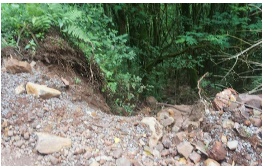
Figura 12: Erosão de bordo identificada na estaca km 4+460.
