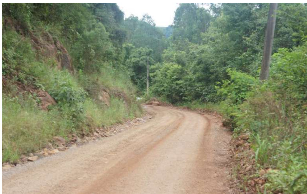
Figura 17: Início de desmoronamento na estaca km 6+330.
