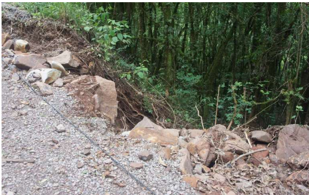
Figura 13: Erosão de bordo identificada na estaca km 4+550.
