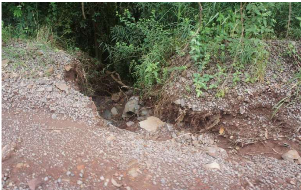
Figura 11: Sulgo erosivo identificado na estaca km 3+280.
