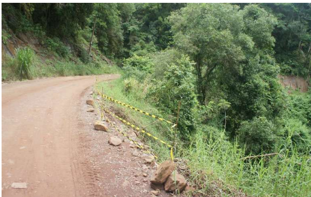
Figura 20: Erosão de bordo e deslizamento identificada na estaca km 6+570.
