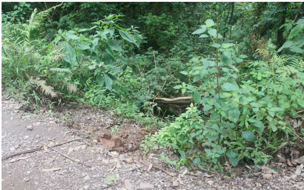
Figura 16: Erosão de bordo identificada na estaca km 5+600.
