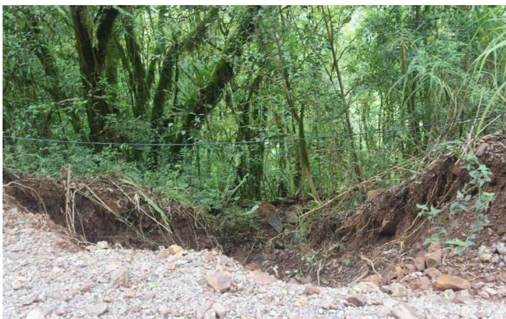
Figura 14: Erosão de bordo identificada na estaca km 4+630.
