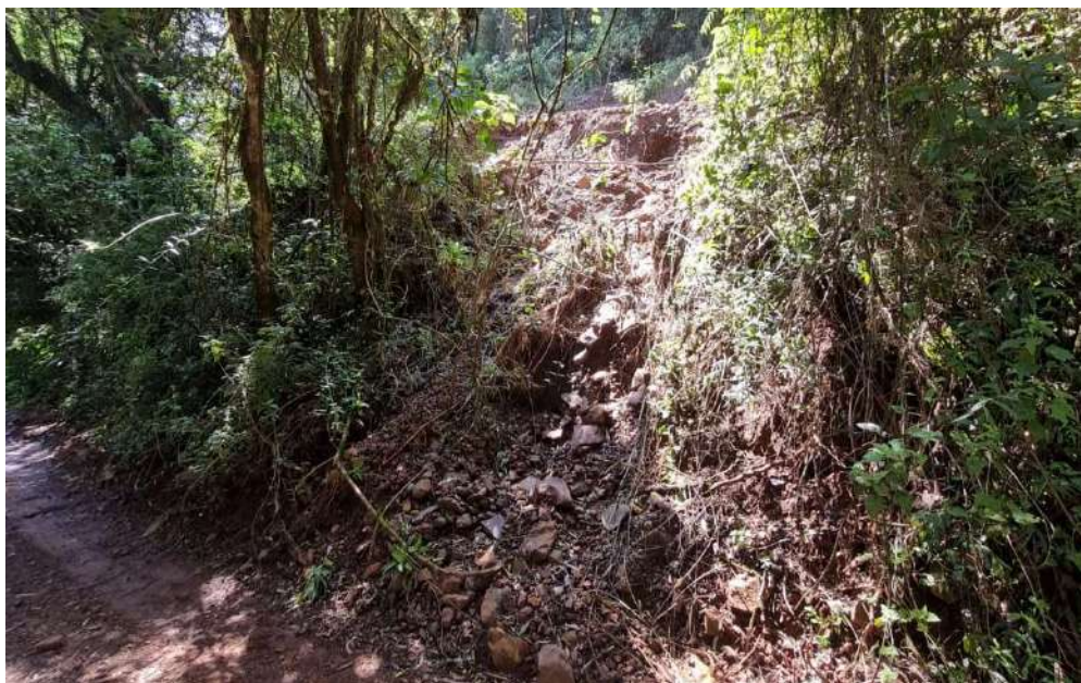
Figura 19: Ápice de desmorronamento na estaca km 6+350.
