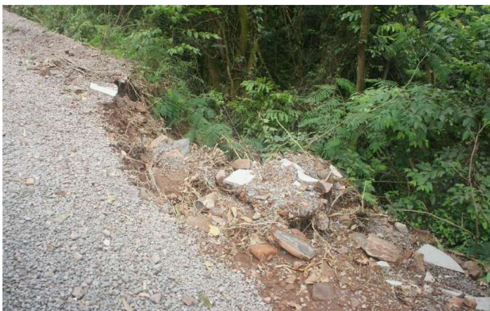
Figura 8: Erosão do bordo identificada na estaca km 2+780.
