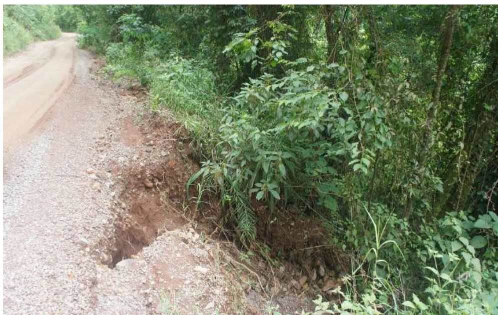
Figura 22: Erosão de bordo identificado na estaca km 6+700.
