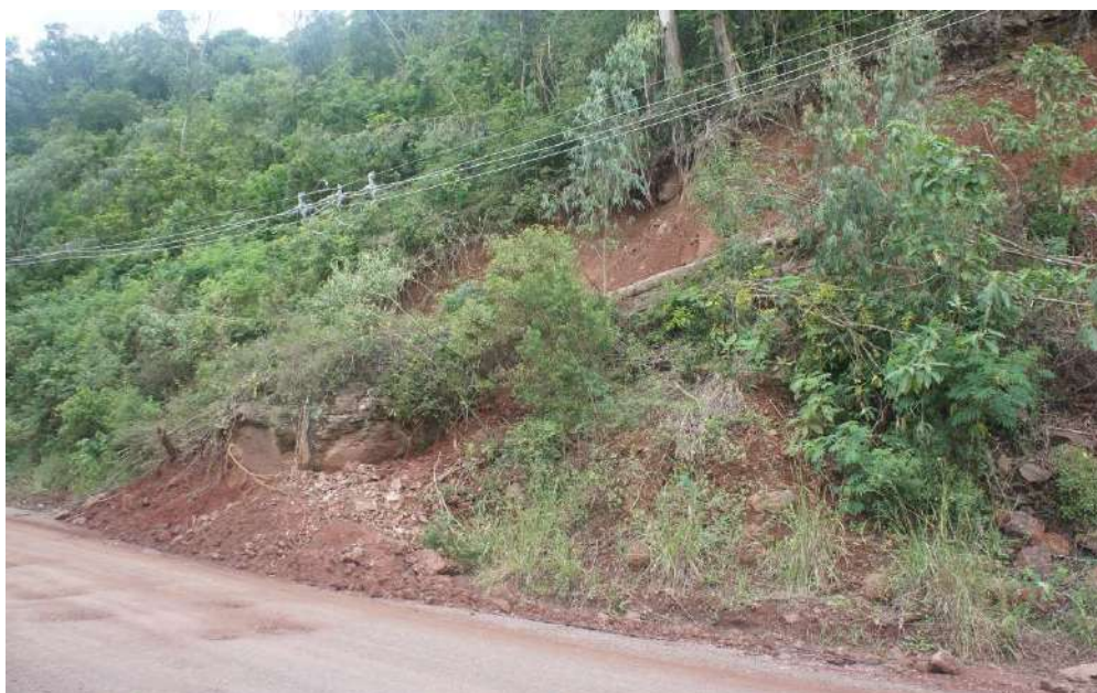
Figura 4: Escorregamento de talude na estaca km 1+920.
