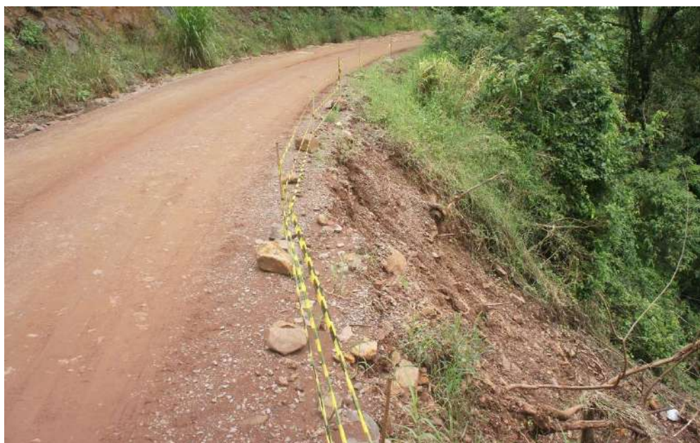
Figura 21: Erosão de bordo e deslizamento identificado na estaca km 6+570.
