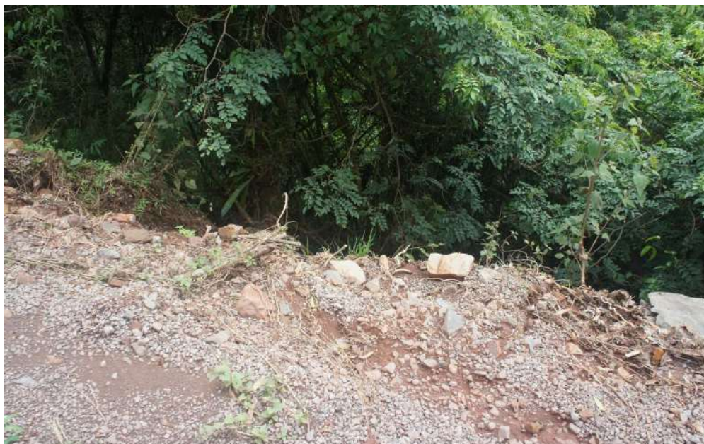
Figura 9: Erosão de bordo identificada na estaca km 3+080.
