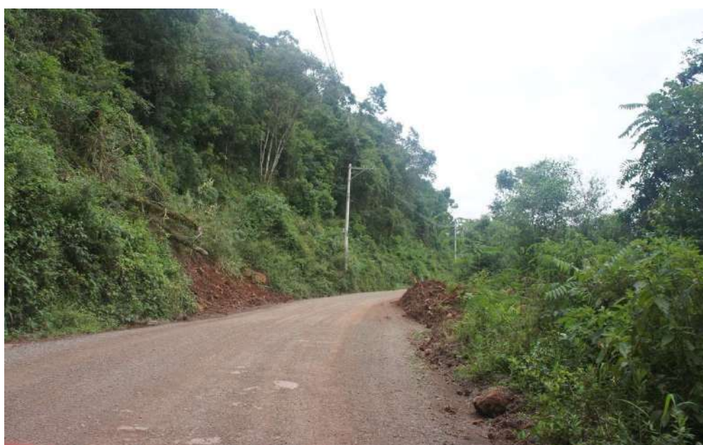
Figura 6: Escorregamento de talude na estaca km 2+240.
