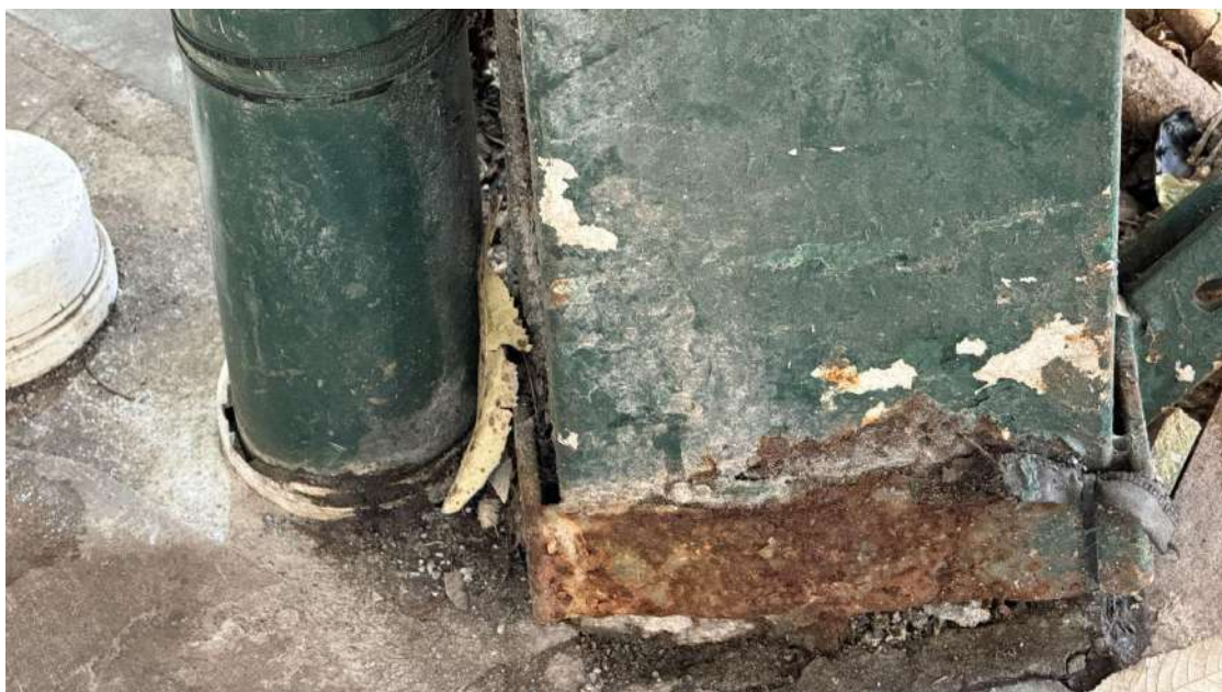
Foto 10 — Detalhe da base de pilar metálico com oxidação aparente
