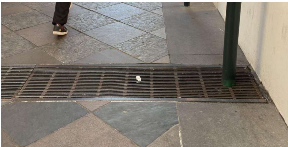
Foto 18 — Interferência entre pilar estrutural e grelha de drenagem transversal
