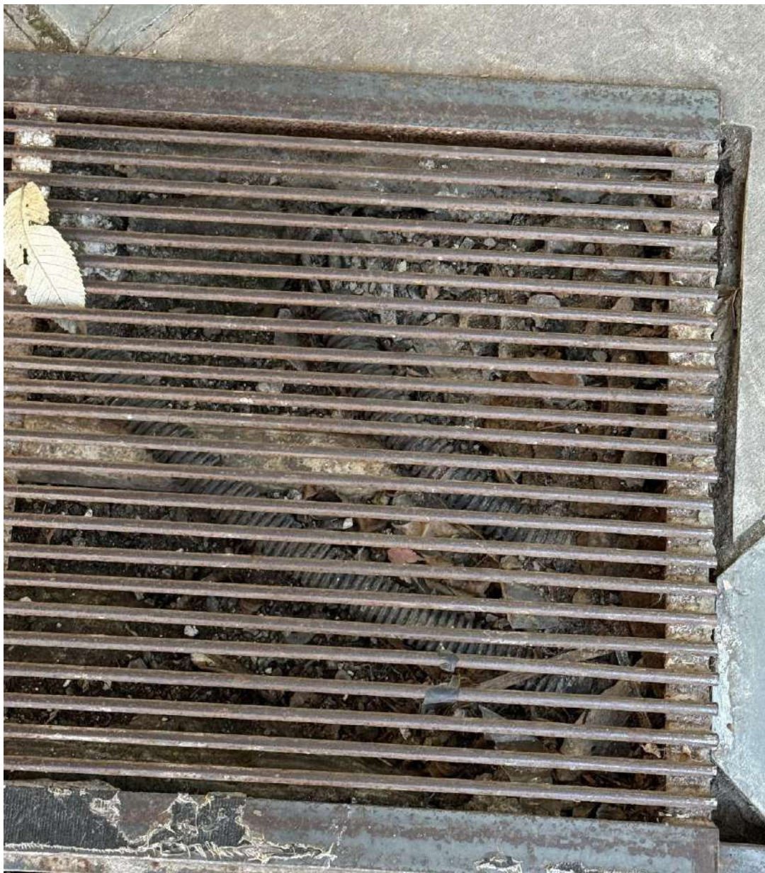
Foto 35 — Detalhe de obstrução e fiação interna em canaleta de drenagem
