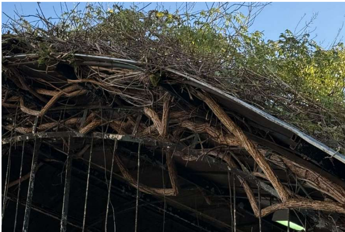
Foto 38 — Detalhe de sobrecarga mecânica e entrelaçamento severo de vegetação na estrutura
