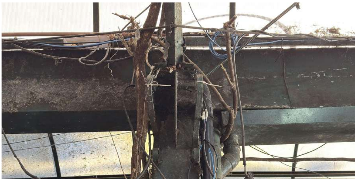
Foto 22 — Detalhe de fiação solta, plugue pendente e interferência com vegetação
