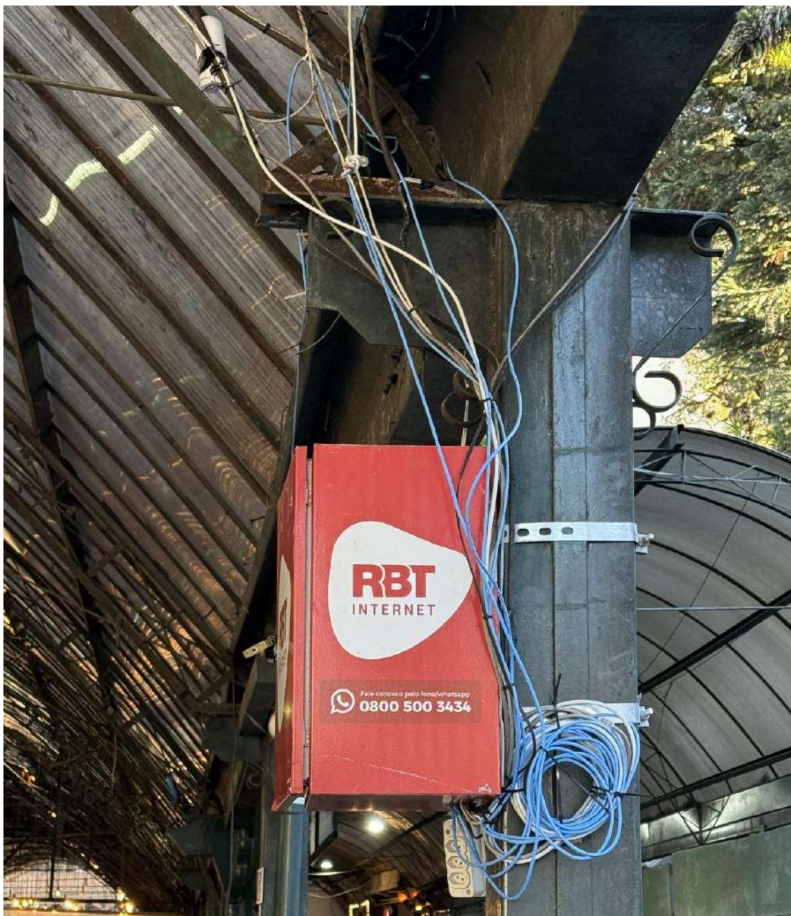
Foto 34 — Detalhe de armário de dados e cabeamento exposto em pilar metálico
