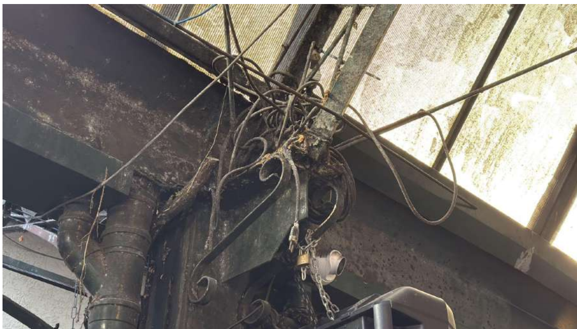
Foto 20 — Detalhe de emaranhado de fiação elétrica em nó estrutural superior
