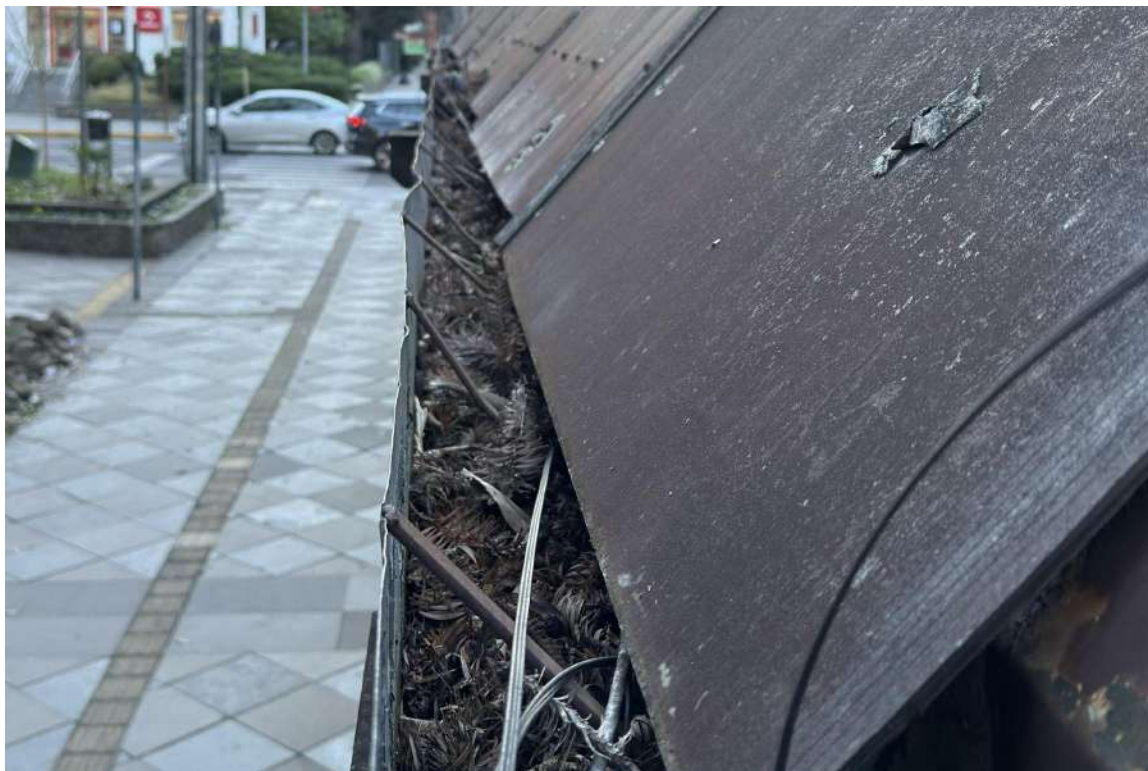
Foto 37 — Detalhe de calha perimetral e acúmulo severo de resíduos
