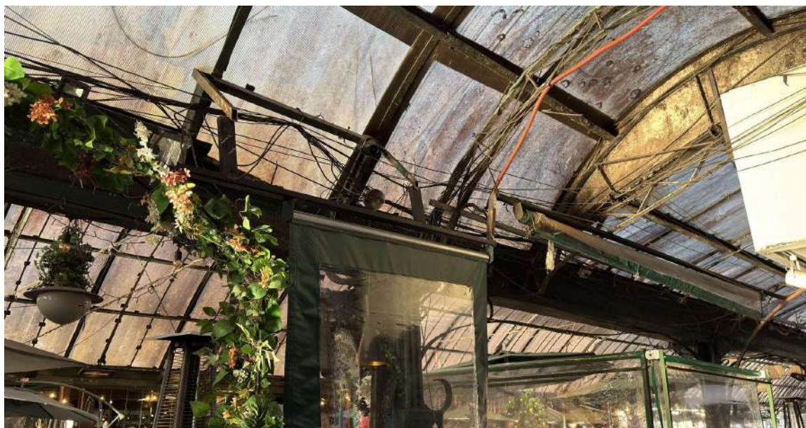
Foto 06 — Detalhe da face interna da cobertura e fiação suspensa
