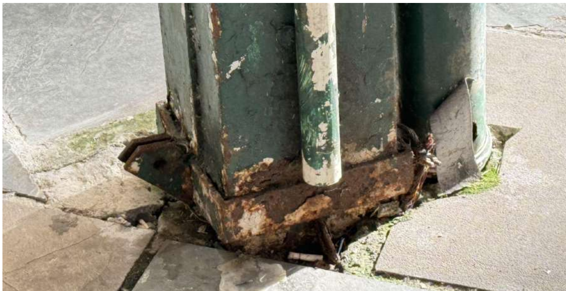
Foto 12 — Detalhe de oxidação na base de pilar metálico
