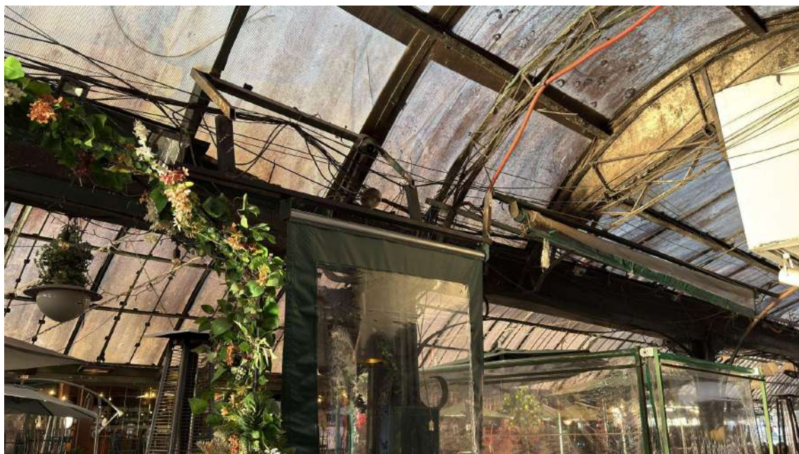
Foto 21 — Vista de cabeamentos aéreos expostos sob os arcos da cobertura
