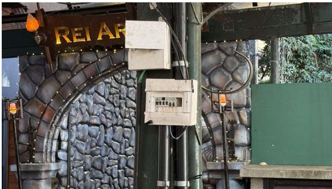
Foto 24 — Detalhe de quadros elétricos e disjuntores expostos em pilar
