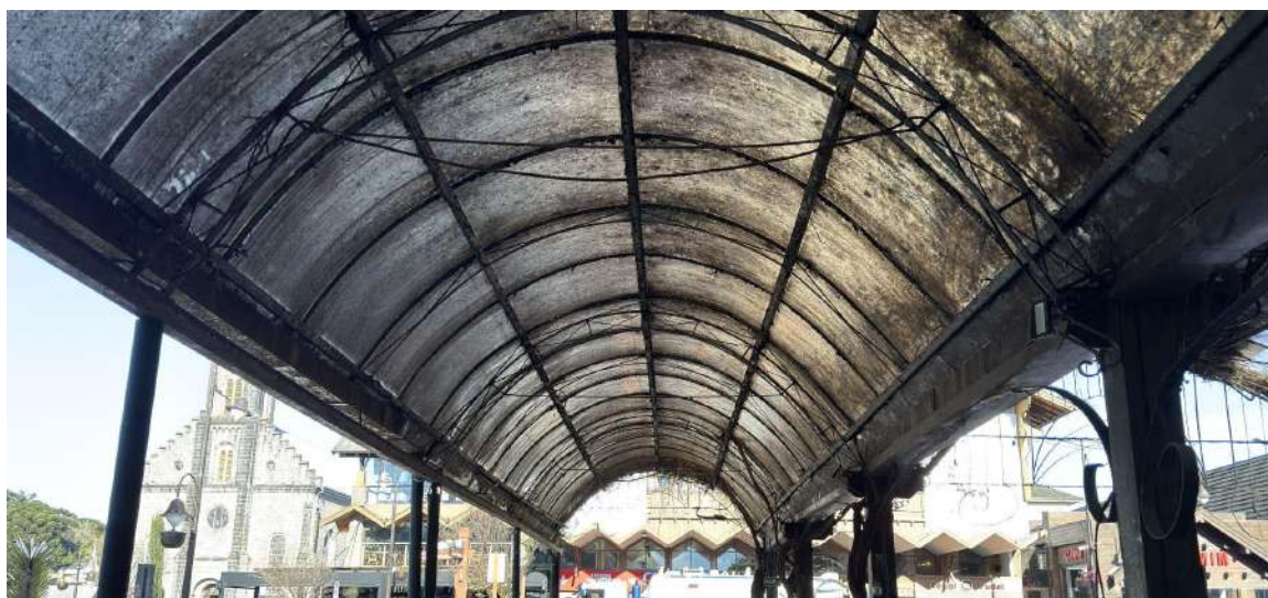
Foto 07 — Detalhe de abóbada secundária e acúmulo de sujeira
