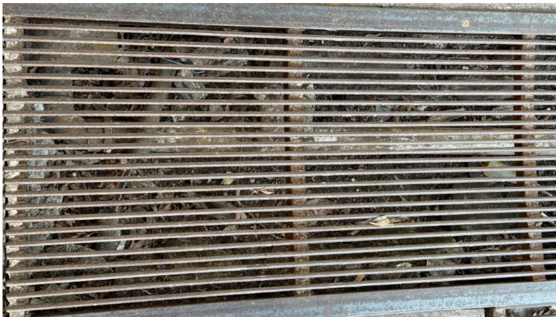
Foto 17 — Grelha de drenagem de piso com detritos e interferência elétrica exposta
