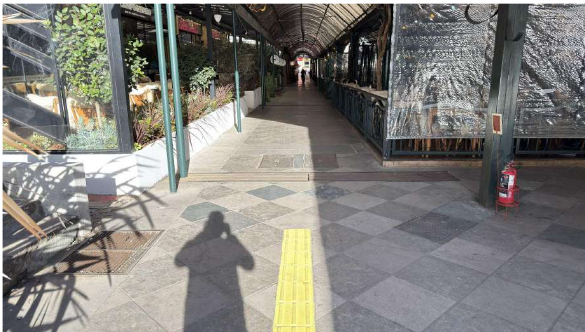
Foto 15 — Canaleta de drenagem e descontinuidade da rota tátil de acessibilidade
