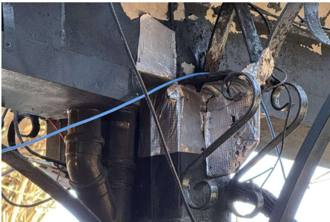
Foto 33 — Detalhe de conexão superior com vedação improvisada e fiação aparente
