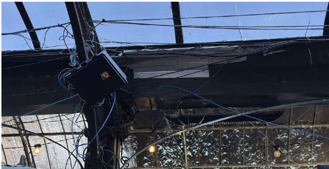
Foto 25 — Cabeamentos aparentes e caixa de passagem junto à cobertura
