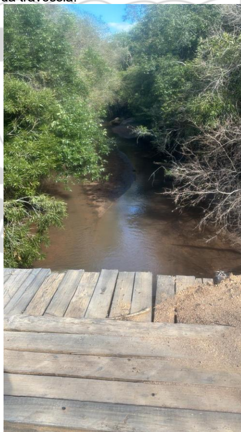
Figura 3 – Condição atual do local onde será reconstruída a ponte.
