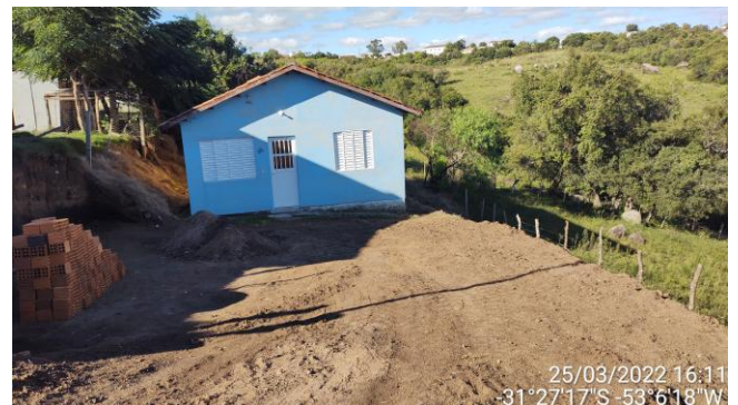
Figura 9 – Rua Inácio Lopes Guterres Estaca 4;
