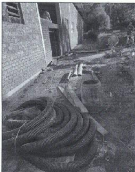
Figura 4 - Situação local com o dreno entupido
