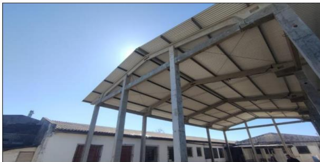
Figura 1 - Cobertura instalada na escola
