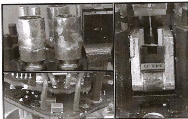
Não foram identificados danos acentuados nos componentes eletrônicos, apenas sujeidade e desgaste natural de uso.
