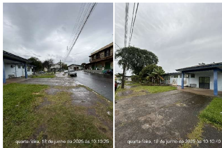
Figura 10 - Calçada a ser refeita
