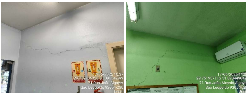
Figura 6 - Exemplo de fissuras a serem tratadas
