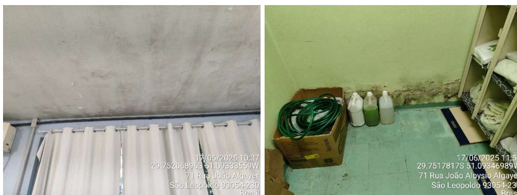
Figura 1 - Exemplos de laje e parede com bolor
