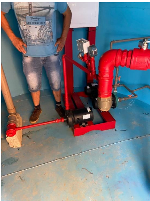
Bombas existentes no local a ser readaptado o sistema
