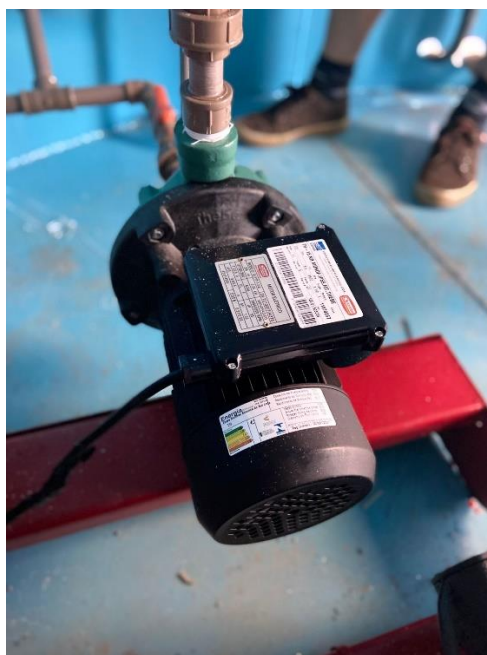
Bombas existentes no local readaptar sistema
