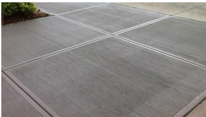
Figura 7 – Acabamento superficial vassourado.
