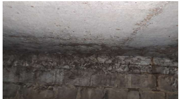
Foto 11 - Junção parede laje
