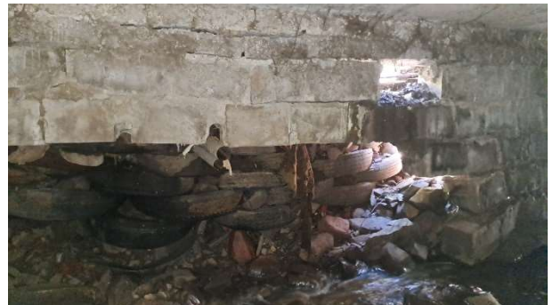
Foto 34 - parede lateral que cedeu, com abertura para área externa
