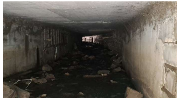
Foto 21 - acúmulo de sedimentos no leito da galeria
