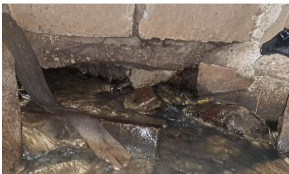
Foto 25 - Deterioração da base por abrasão e cavitação
