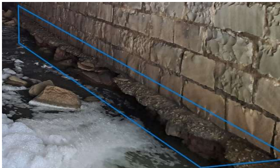
Foto 8- Rebaixo no piso da galeria por erosão na entrada sul
