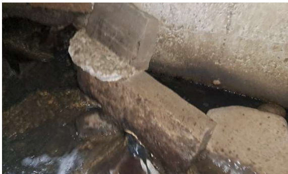
Foto 24 - Parte da estrutura desprendida
