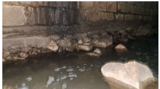
Foto 28 - deterioração da base da parede leste
