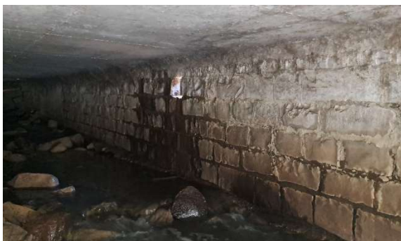
Foto 10 - Entrada de água externa
