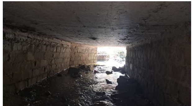
Foto 12 - deposição de partes da estrutura que se soltaram na saída da galeria
