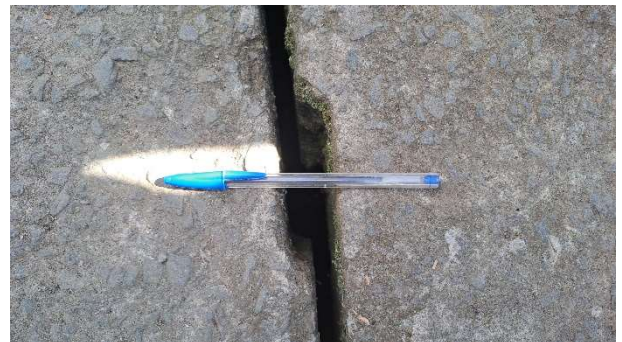
Foto 5- Fresta entre as lajes de cobertura
