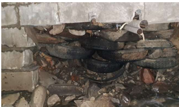
Foto 33 - Parede lateral oeste que cedeu
