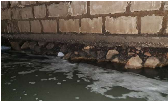
Foto 30 - deterioração da base da parede oeste
