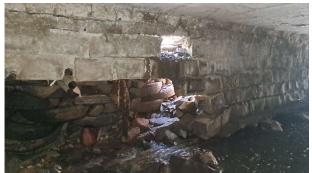
Foto 36 - Parede lateral que cedeu
