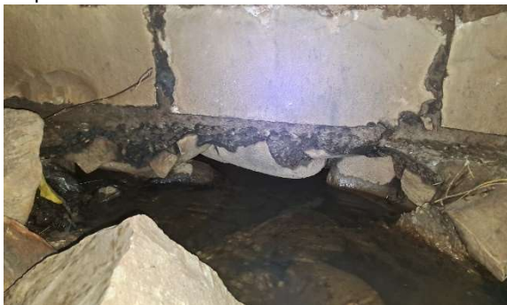
Foto 18 - Erosão na base da parede oeste
