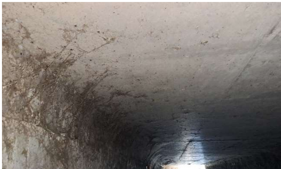
Foto 22 - Junção laje parede
