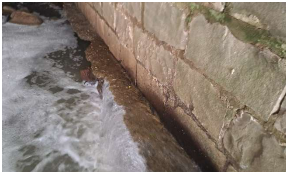
Foto 7- Desgaste por cavitação próximo a entrada sul
