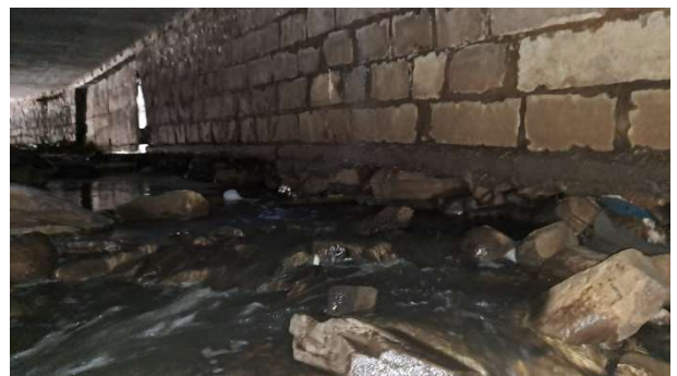
Foto 29 - deterioração da base da parede oeste
