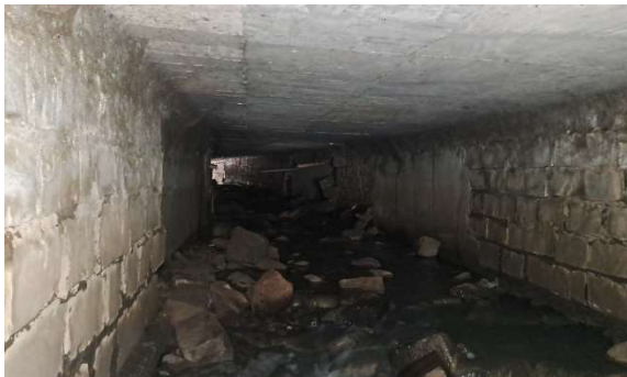
Foto 15 - Deposição de blocos que se desprenderam da estrutura no leito da galeria
