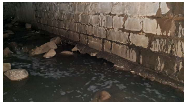
Foto 14 - Rebaixo no piso da galeria por erosão na entrada norte
