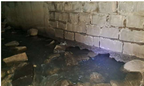
Foto 17 - Rebaixo no piso da galeria por erosão na parede oeste
