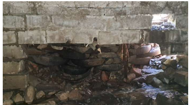
Foto 35 - Parede lateral que cedeu
