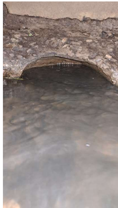
Foto 20 - Degradação da base das paredes
