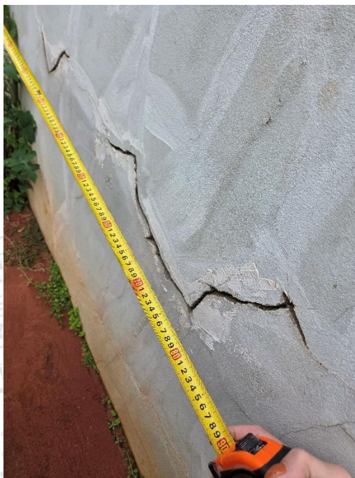
Figura 3 - Trinca parede refeitório
