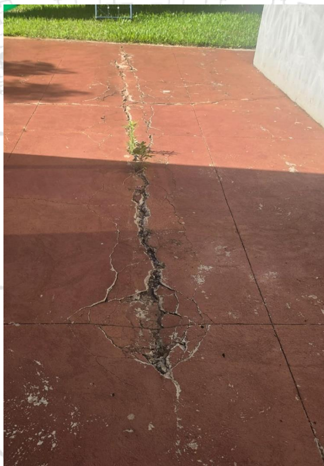
Figura 8 - Calçada que deve realizado o reparo
