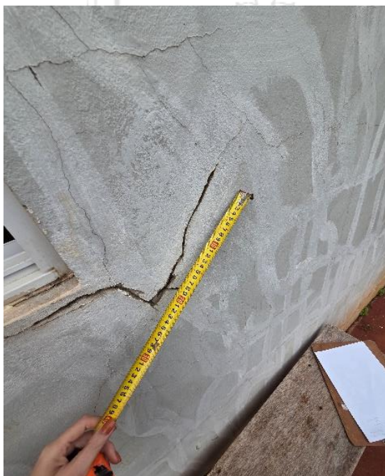
Figura 1 Trinca janela refeitório
