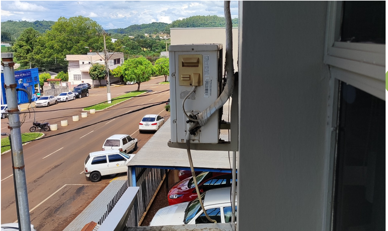
Figura 2: Unidade condensadora da Sala da Presidência. O acesso à marquise é possível sem uso de escada.
