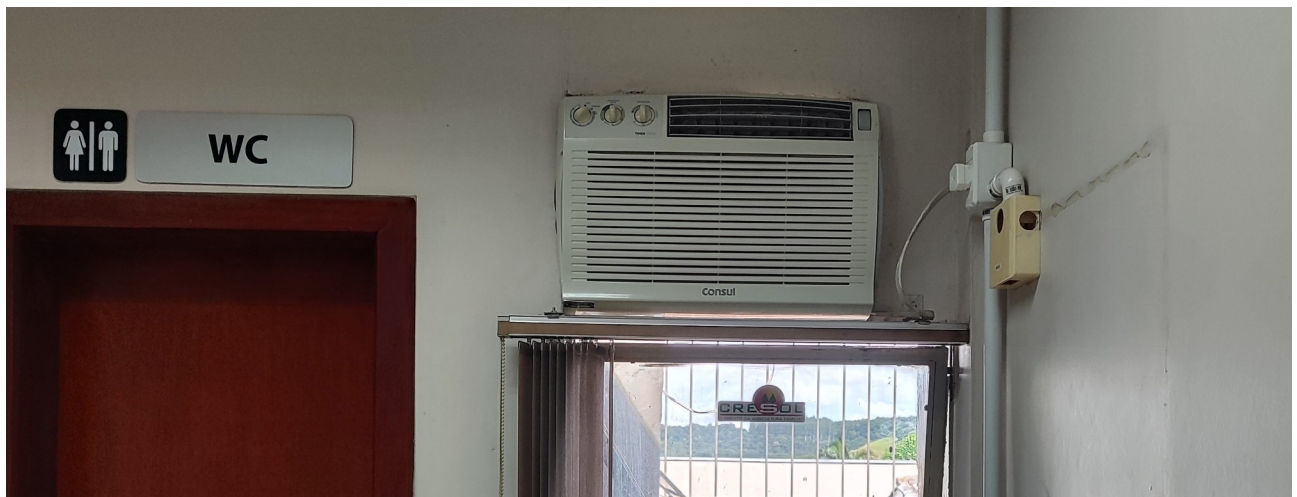
Figura 4: Ar-condicionado modelo janela na sala da Bancada do PP.
