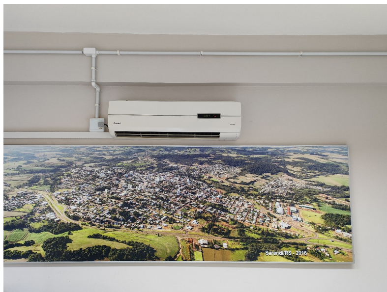
Figura 1: Unidade evaporadora localizada na Sala da Presidência. Será substituída por equipamento novo.
