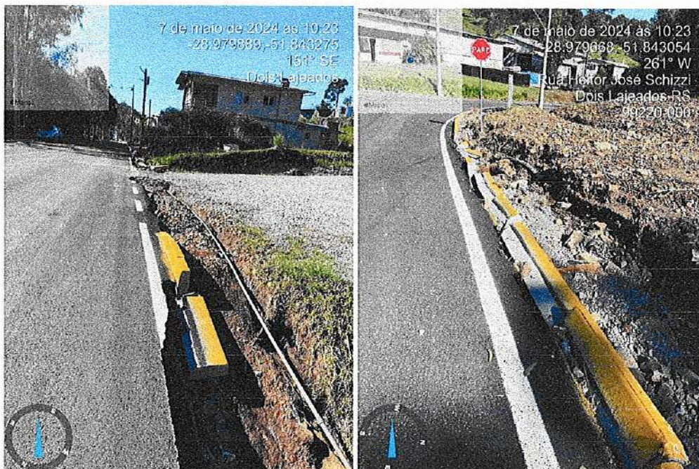
Bordas do asfalto danificadas, além de queda de meio fio.
