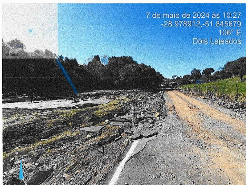
Asfalto "deslocado" para a lateral.
