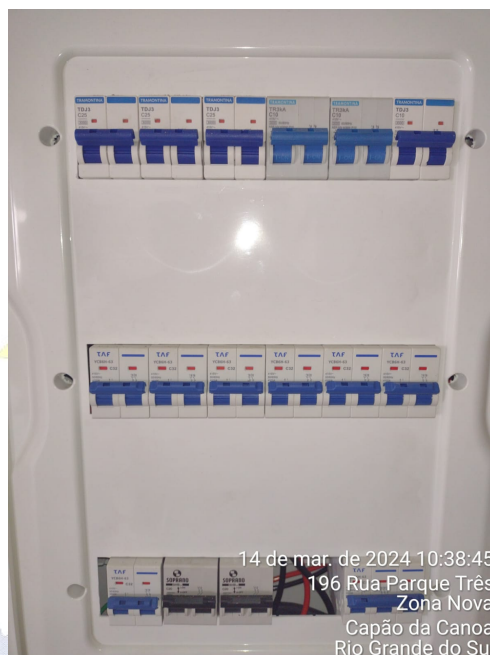
Figura 2 – Quadro com proteção.
