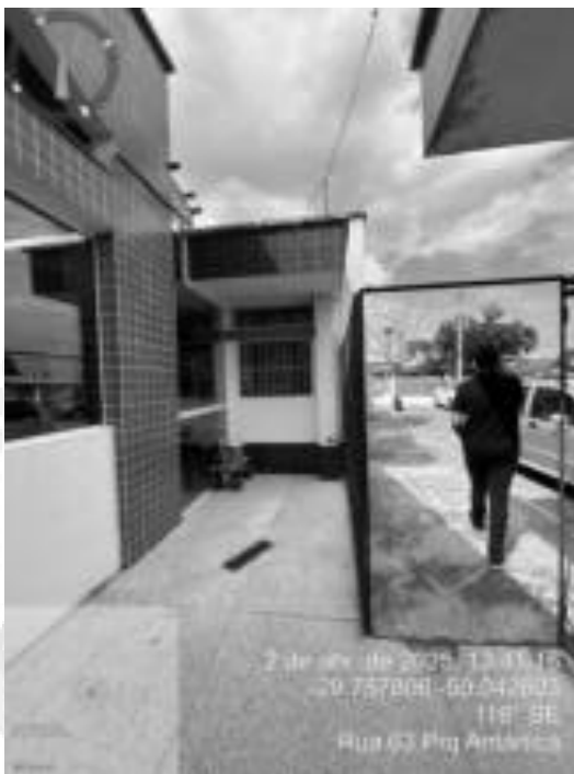
Figura 32: piso em granitina que necessita de reparos
