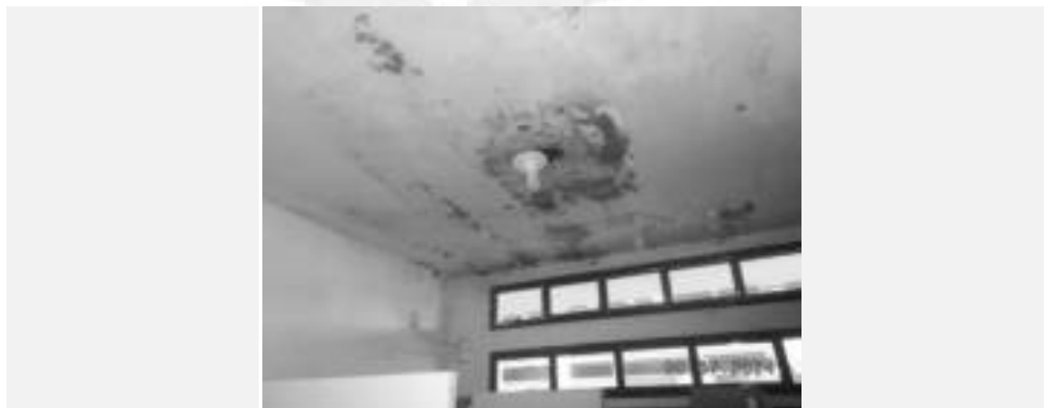
Figura 3: Teto interno danificado devido as infiltrações do telhado
