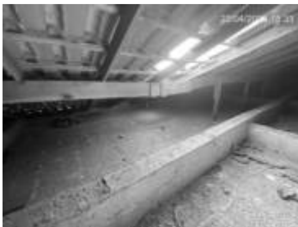
Figura 4: Parte do telhado que deve ter o madeiramento substituído
