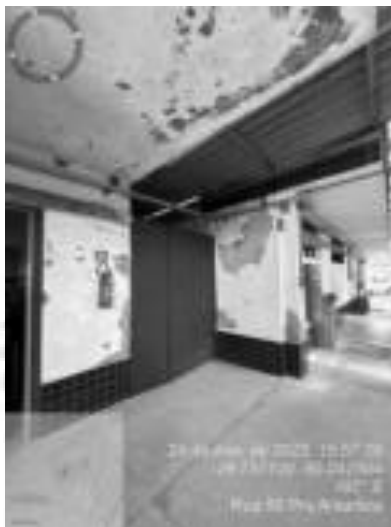
Figura 16: Parede e teto com reboco comprometido
