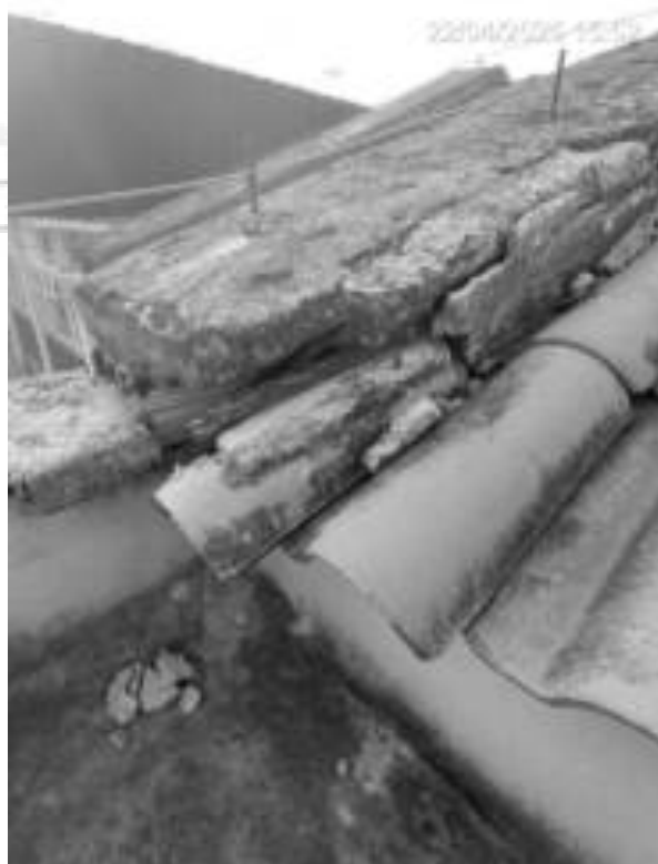
Figura 12: rufo em concreto com enchimento, mostrando telha que deverá ser retirada e posteriormente reposicionada para instalação de calha em alumínio;
