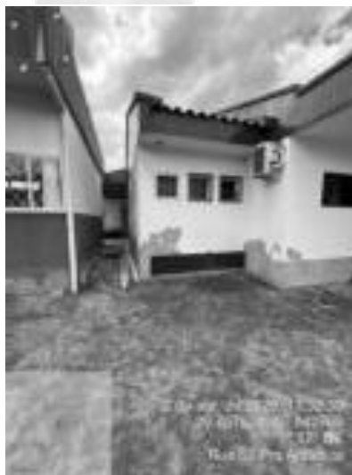
Figura 15: Parede com reboco danificado e molduras que devem ser removidas
