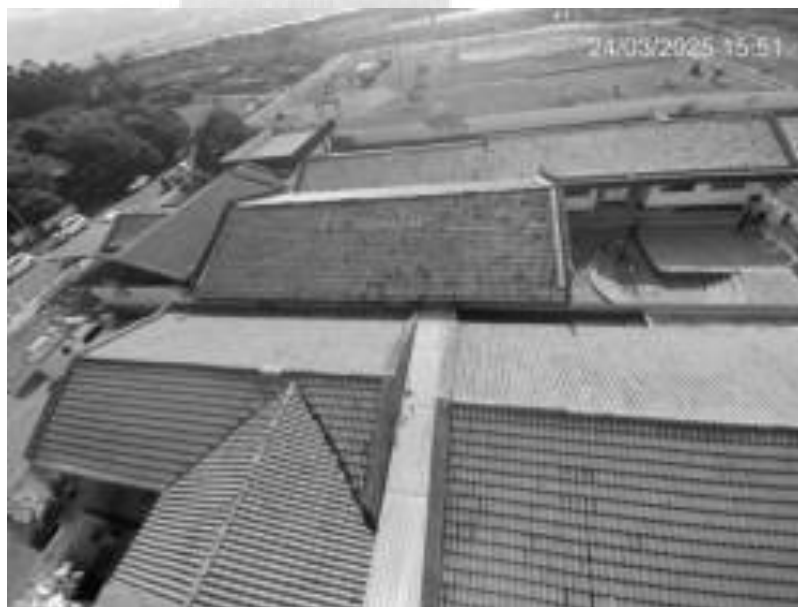
Figura 1: Imagem do telhado existente que necessita de reforço e ser refeito em ponto específico
