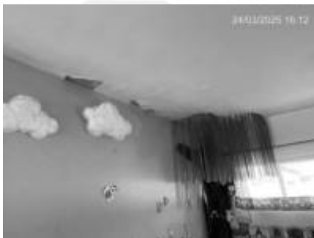
Figura 18: danos no teto das salas
