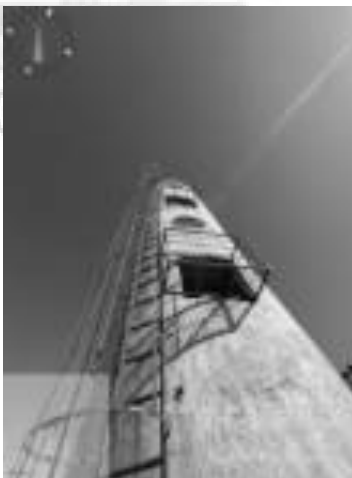
Figura 26: Esquadrias circulares que serão substituídas e vão quadrados que terão esquadrias inseridas
