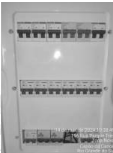
Figura 28: Quadro com proteção.
