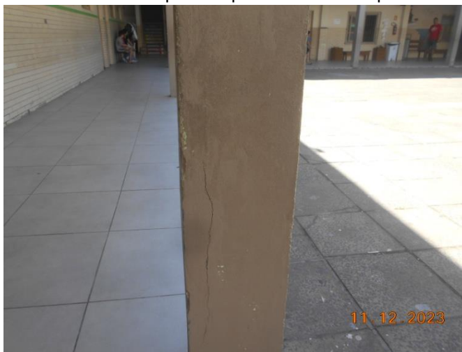
Figura 33: Detalhe dos pilares que necessitam reparo estrutural
