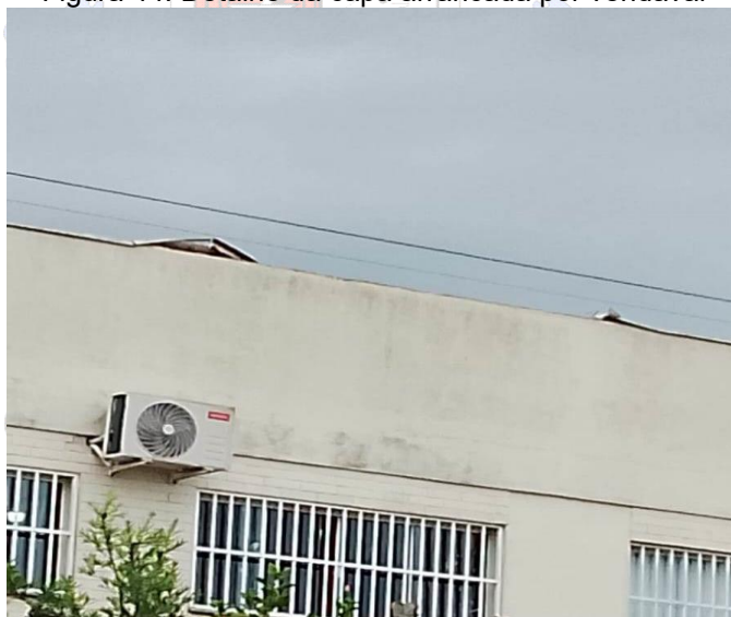
Figura 44: Detalhe da capa arrancada por vendaval
