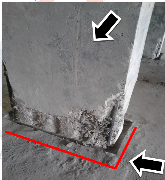
Figura 34: Detalhe do pilar desbastado e do recorte correto na base do piso
