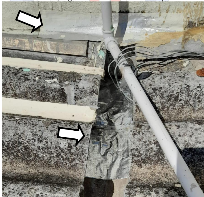
Figura 43: Detalhe de calha, algeroz e manta aluminizada precária sobre o telhado
