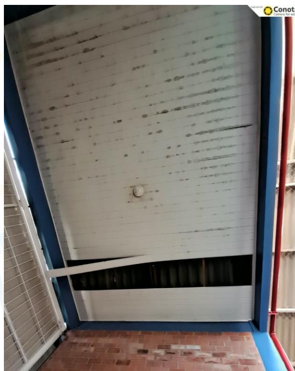
Figura 2 – Detalhe do forro danificado
