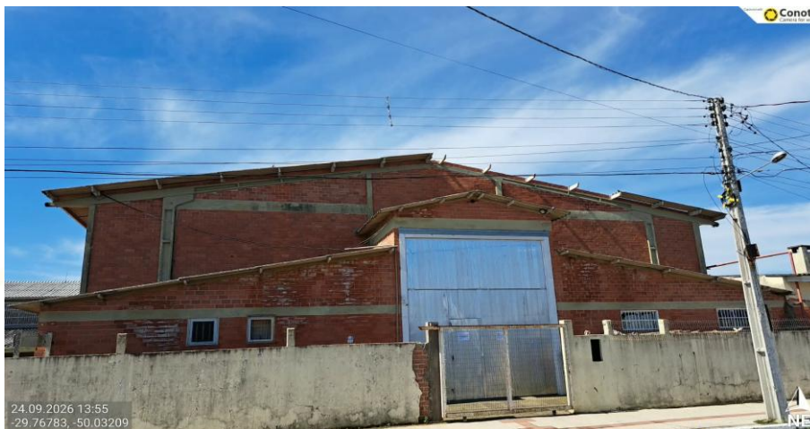
Figura 4 – Visão externa das telhas arrancadas no Ginásio de Esporte
