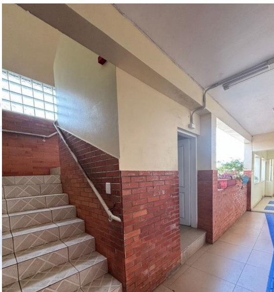
Figura 15: Rede elétrica próxima do local do novo sanitário
