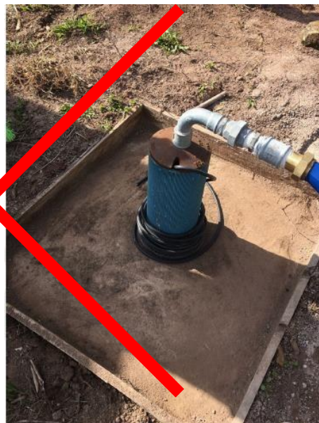
Laje sanitária abaixo do nível do seu entorno.
