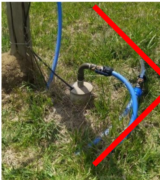
Falta de laje sanitária
