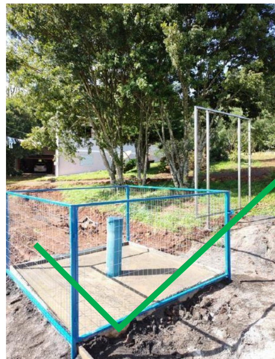
Cercamento completo de forma a impedir o acesso ao poço (mínimo 2x2 m 2 ).
