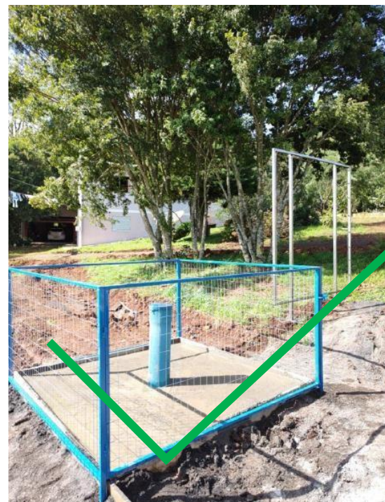
Cercamento completo de forma a impedir o acesso ao poço (mínimo 2x2 m 2 ).
