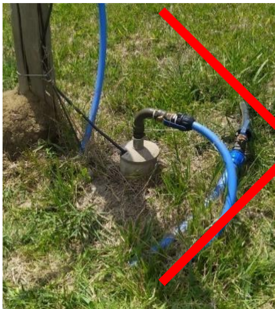
Falta de laje sanitária
