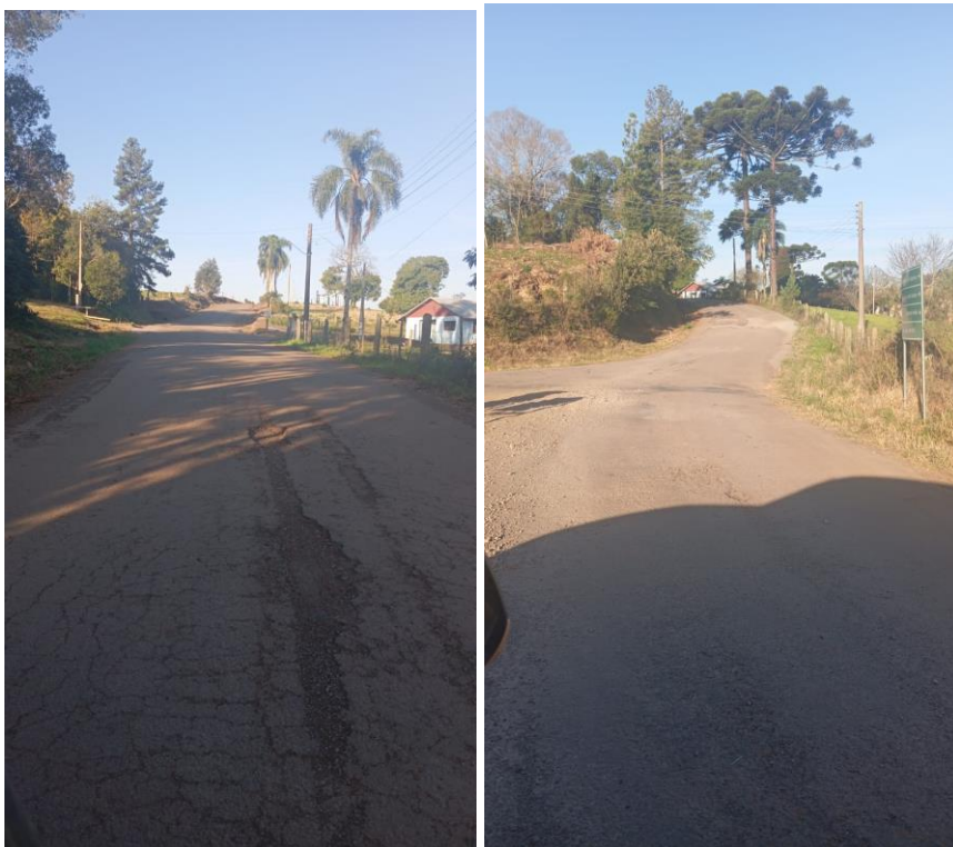
Patologias identificadas do trevo + 700,00 metros
