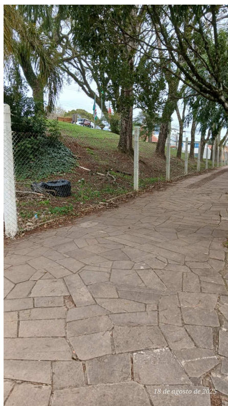
Figura 1 – Situação do passeio público pavimentado no acesso a edificação.
