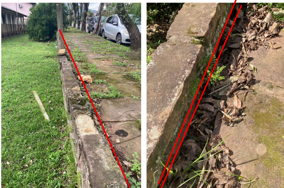
Imagem 05 – Deformação da contenção existente.
