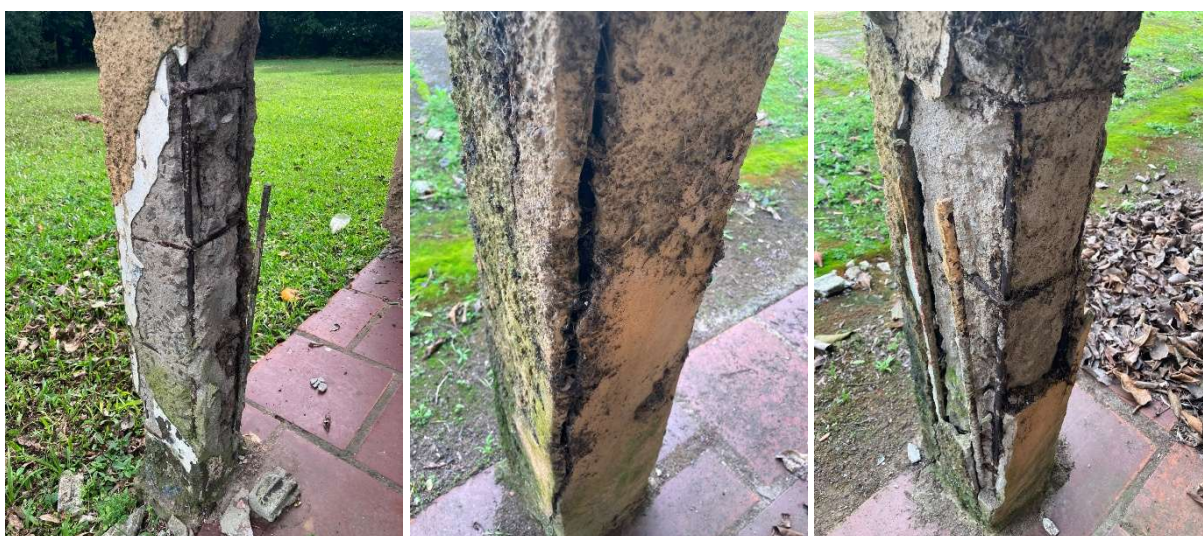
Imagem 04 – Estado de conservação dos pilaretes existentes.
