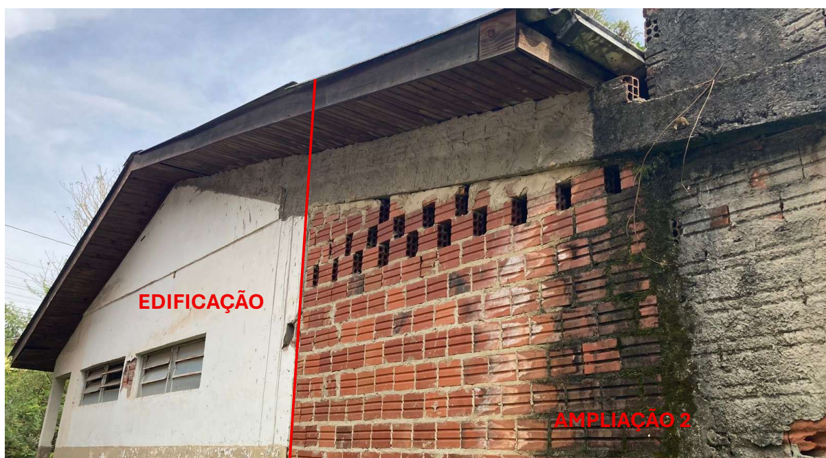
Imagem 02 - Fachada leste, ampliação precária 2.
