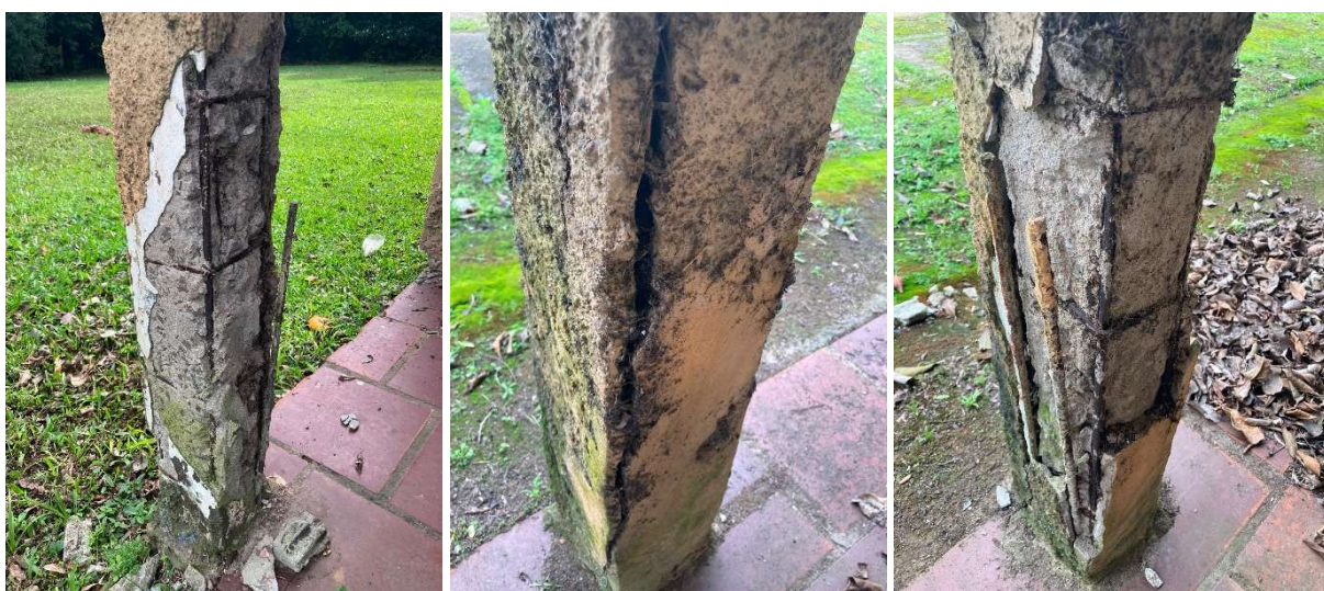
Imagem 04 – Estado de conservação dos pilaretes existentes.
