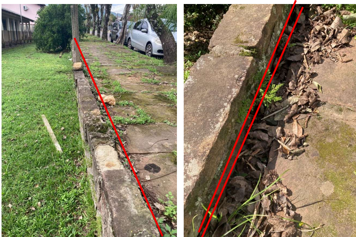
Imagem 05 – Deformação da contenção existente.
