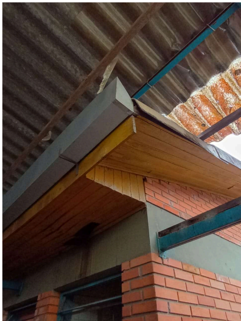
Figura 5: Forro de madeira comprometido. Fonte: Autor.
