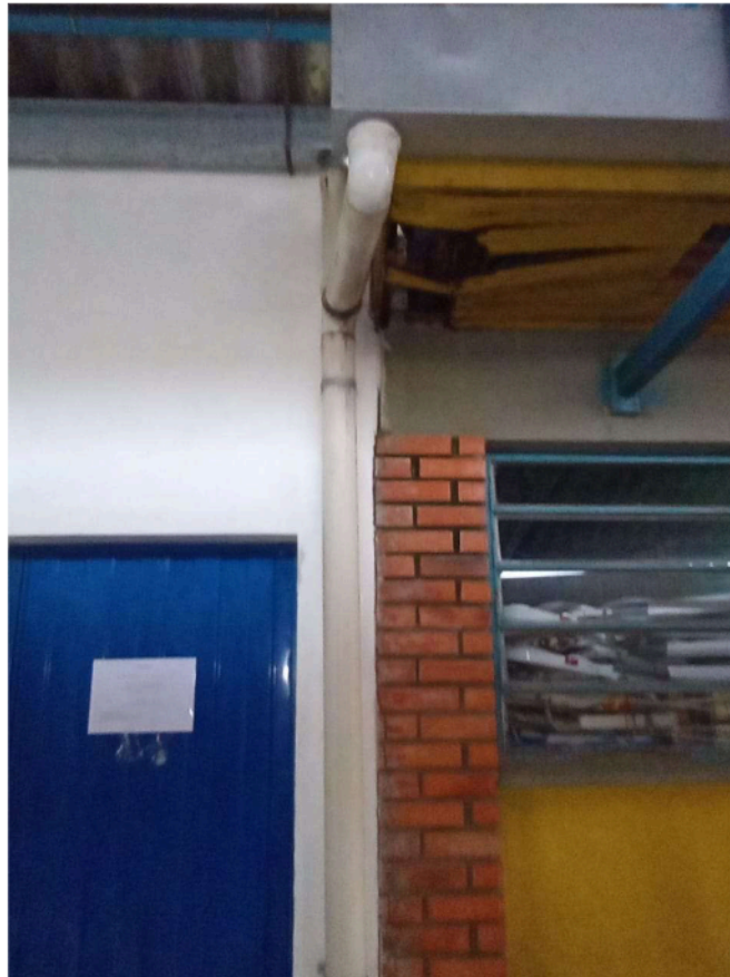
Figura 6: Forro comprometido em razão da infiltração pluvial. Fonte: Autor.
