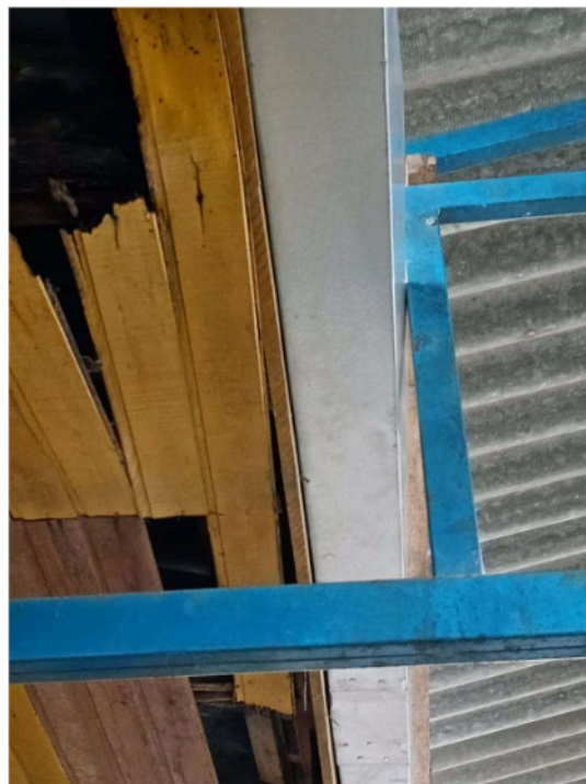
Figura 7: Forro comprometido em razão da infiltração pluvial. Fonte: Autor.
