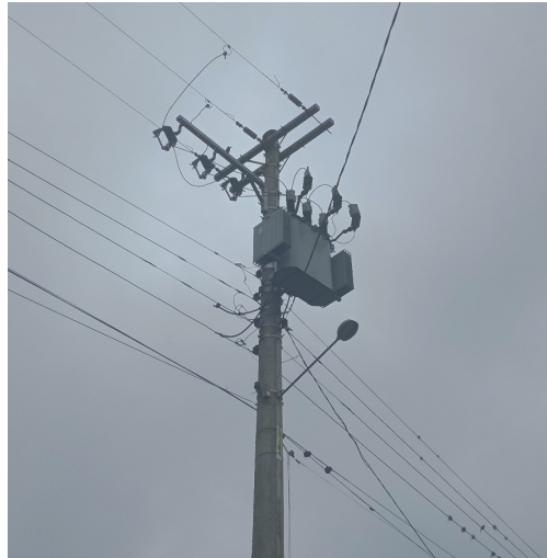
Figura 12: Transformador da RGE em frente a propriedade, com rede trifásica.
