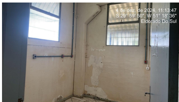
Figura 22 - Detalhe de parede e rodapés descascados.
