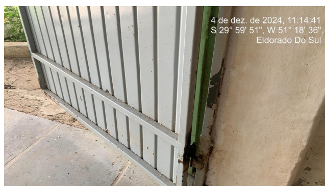
Figura 21 - Detalhe da esquadria de ferro enferrujada.
