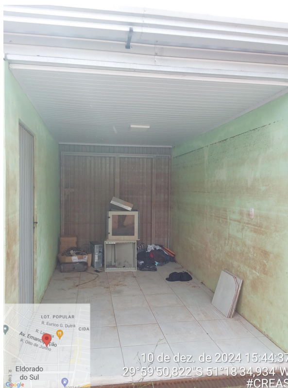
Figura 11 - Área de circulação externa coberta , com porta e gradil ao fundo, paredes sujas e manchadas.
