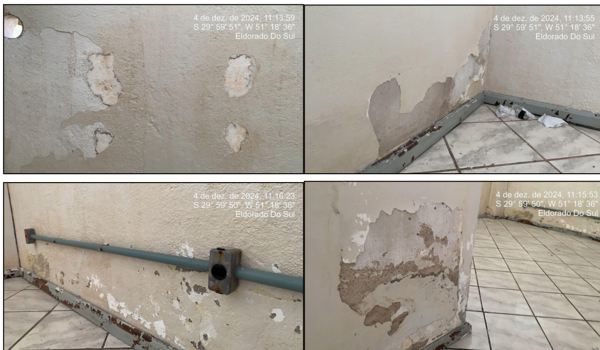
Figura 19 e 20 - Detalhe de parede e rodapés descascados.
