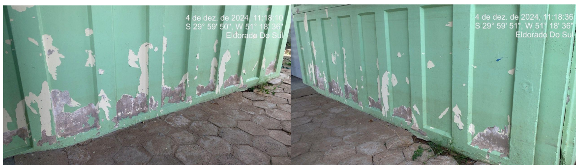
Figura 24 - Detalhes de parede externa descascada.
