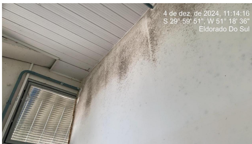
Figura 12 - Parede manchada junto ao forro, pela umidade.
