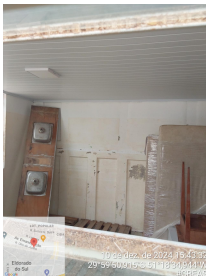
Figura 23 - Detalhe de paredes manchadas.
