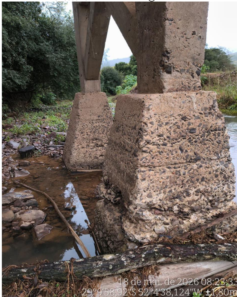
Fotografia 8: Vista aproximada dos pilares centrais da ponte, evidenciando o intenso processo de desgaste superficial do concreto por abrasão hidráulica e impacto de detritos, com exposição dos agregados graúdos. Fundações expostas pela erosão do leito do arroio – 18/05/2026. Coordenadas: 29°9'58,92"S 52°4'38,124"O. Fonte: Prefeitura Municipal de Relvado/RS.
