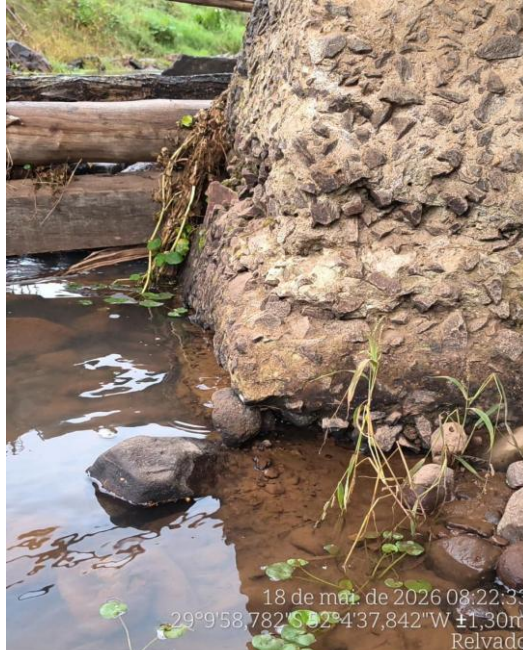
Fotografia 9: Detalhe da base dos pilares centrais, mostrando erosão severa e solapamento da fundação. Troncos aprisionados na base atestam o impacto de detritos de grande porte nas cheias anteriores – 18/05/2026. Coordenadas: 29°9'58,782"S 52°4'37,842"O. Fonte: Prefeitura Municipal de Relvado/RS.
