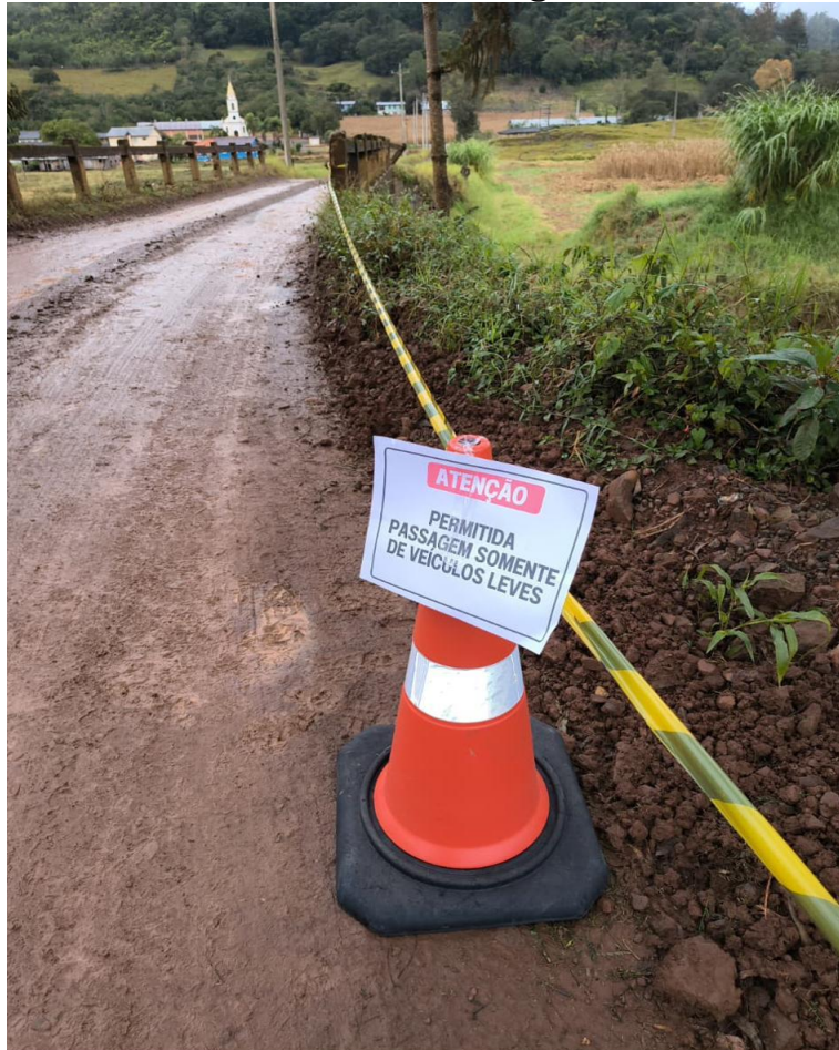
Fotografia 12: Sinalização de restrição de tráfego implantada pela Prefeitura Municipal no acesso à ponte – "Permitida Passagem Somente de Veículos Leves". A ausência de bloqueio total deveu-se à impossibilidade prática de desvio de rota para os moradores da comunidade. Fonte: Prefeitura Municipal de Relvado/RS – jun/2026.
