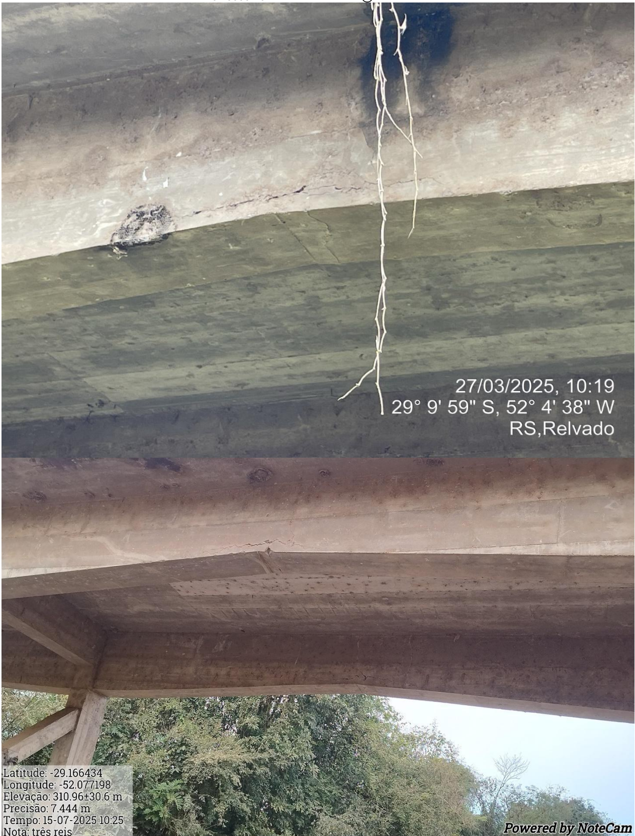
Fotografia 3 (acima – 27/03/2025) e Fotografia 4 (abaixo – 15/07/2025): Evolução das fissuras de cisalhamento no intradós das vigas principais. Na imagem superior, fissura inicial com orientação vertical; na inferior, abertura já
