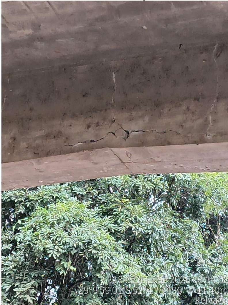
Fotografia 7: Fissura de cisalhamento na face lateral da viga principal, com corrosão ativa visível das armaduras e expansão das fissuras por produtos de corrosão – vistoria de 18/05/2026. Coordenadas: 29°9'59,01"S 52°4'38,196"O. Fonte: Prefeitura Municipal de Relvado/RS.
