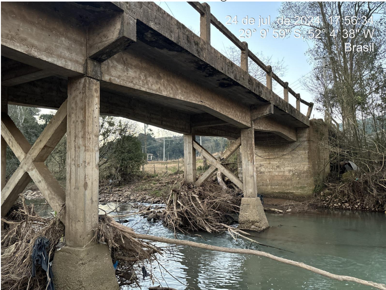
Fotografia 2: Acúmulo de detritos lenhosos (troncos e galhos) nos pilares da ponte após evento de cheia – 24/07/2025. O material aprisionado entre os pilares atua como barreira, amplificando as forças hidrodinâmicas sobre a estrutura. Início de rachaduras na viga. Coordenadas: 29° 09' 59" S / 52° 04' 38" O. Fonte: Prefeitura Municipal de Relvado/RS.
