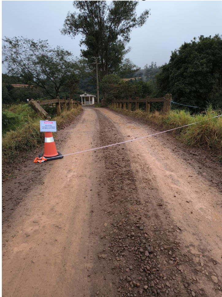
Fotografia 13: Vista frontal da ponte com sinalização de interdição. A estrutura, embora ainda em pé, apresenta visível deterioração dos elementos de proteção lateral (balaústres fraturados) e comprovada instabilidade das vigas principais. Fonte: Prefeitura Municipal de Relvado/RS – jun/2026.
