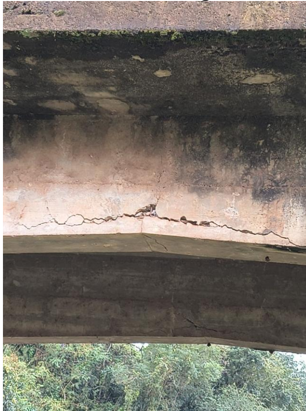
Fotografia 11: Fissura longitudinal de grande extensão no intradós da viga, com abertura superior a 1,0 cm, propagação ramificada (dendrítica) e exposição da armadura longitudinal com corrosão ativa – 18/05/2026. Fonte: Prefeitura Municipal de Relvado/RS.
