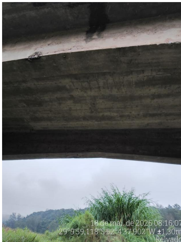
Fotografia 10: Vista do intradós das vigas principais em conjunto, mostrando a extensão das manchas de lixiviação, efflorescências e o início das fissuras longitudinais na interface viga-tabuleiro – 18/05/2026. Coordenadas: 29°9'59,118"S 52°4'37,902"O. Fonte: Prefeitura Municipal de Relvado/RS.
