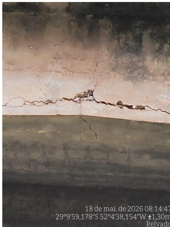
Fotografia 6: Fissura horizontal no plano de encontro viga-tabuleiro (intradós), com propagação longitudinal e descontinuidade completa da aderência viga-tabuleiro – vistoria de 18/05/2026. Coordenadas: 29°9'59,178"S 52°4'38,154"O. Fonte: Prefeitura Municipal de Relvado/RS.
