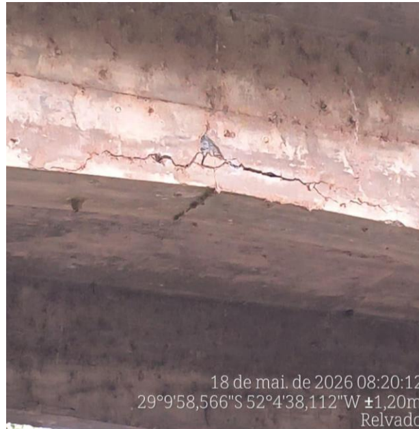
Fotografia 5: Detalhe de fissura de cisalhamento com abertura máxima superior a 1,0 cm e deslocamento generalizado do cobrimento de concreto – viga principal (face inferior), vistoria de 18/05/2026. Coordenadas: 29°9'58,566"S 52°4'38,112"O. Fonte: Prefeitura Municipal de Relvado/RS.
