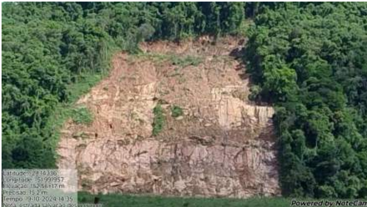
Imagem 08: vista frontal do talude, onde fica evidente a rocha e o material galgado no topo do deslizamento. Coordenadas: latitude -29.14336° e longitude -51.991957°. Data: 19/10/2024. Fonte: Prefeitura de Relvado.
