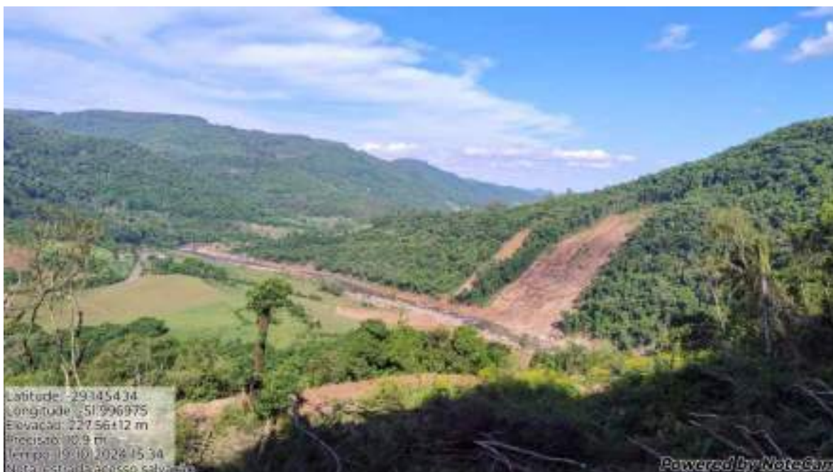
Imagem 09: queda de duas barreiras, correspondentes às Metas 04 e 05, com perda total da pista e evidenciada a inclinação do talude resultante dos movimentos de massa. Coordenadas: latitude -29.145434° e longitude -51.996975°. Data: 19/10/2024. Fonte: Prefeitura de Relvado.
