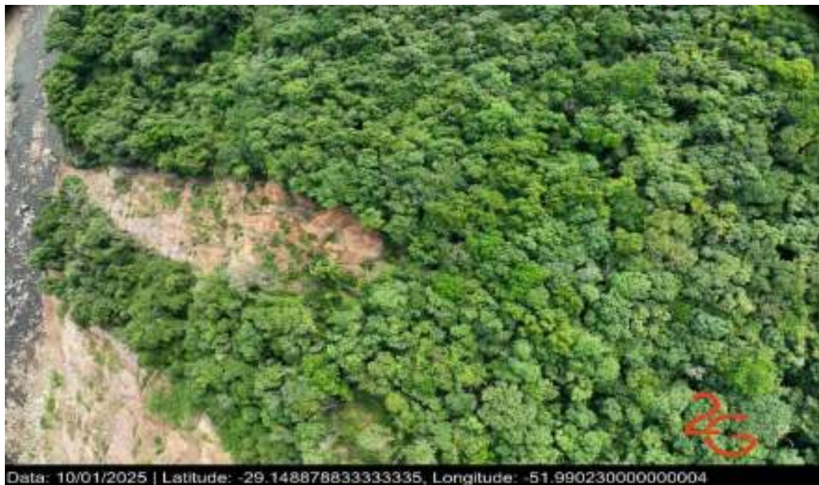
Imagem 11: movimento de massa da meta 05, onde se percebe o horizonte de rocha no talude íngreme. Coordenadas: latitude -29.148878° e longitude -51.990230°. Data: 10/01/2025. Fonte: 2G Topografia.
