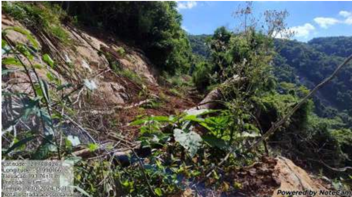
Imagem 10: ponto até onde foi possível chegar com segurança por terra. Evidenciado o talude rochoso onde houve deslizamento do solo. Coordenadas: latitude -29.148426° e longitude -51.990166°. Data: 19/10/2024. Fonte: Prefeitura de Relvado.
