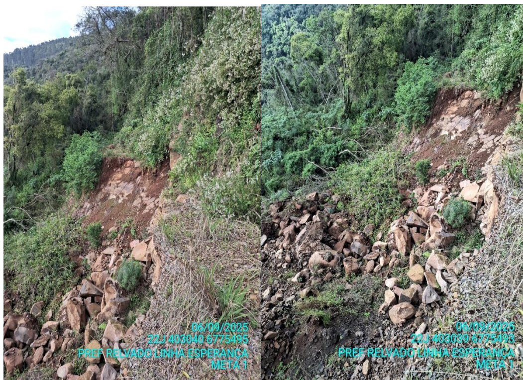
Figura 1 - Queda de blocos de grandes proporções registrada em setembro/2025, junto ao Talude Meta 01 – com a queda total da pista de rolamento.
