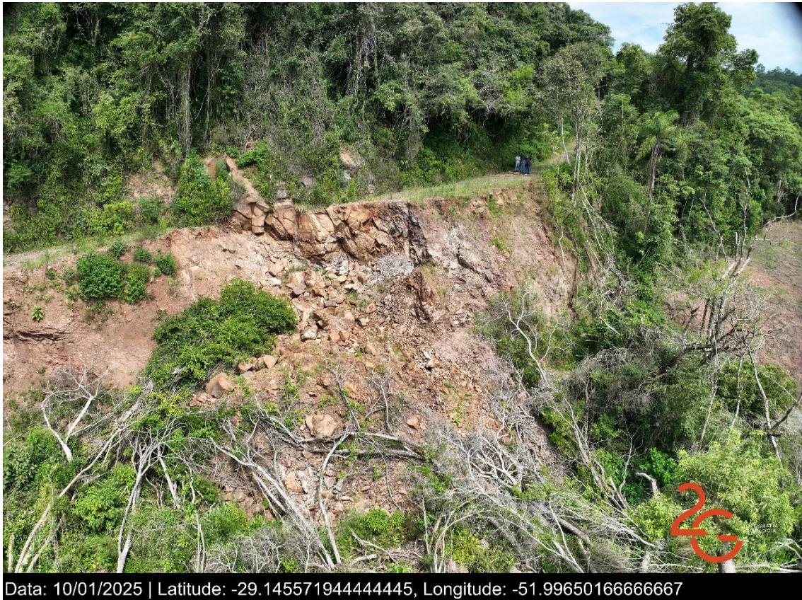
Figura 9 – Situação no ponto META 01, queda de blocos e deslizamento de materiais
