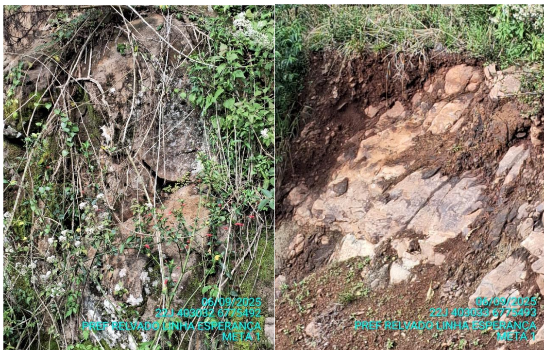
Figura 2 – Maciço rochoso com blocos solto e a associação de material heterogêneo com o leito rochoso.
