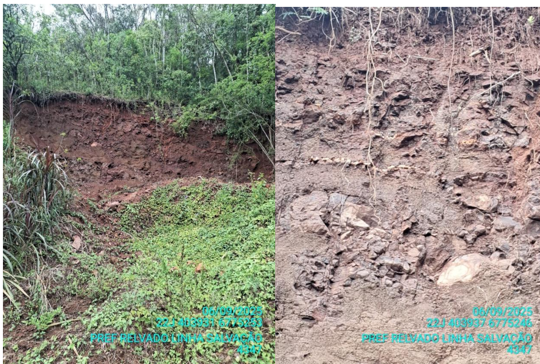
Figura 4 – Exposição do material inconsolidado e heterogêneo em deslizamentos de menor porte, indicando uma tendência ao fluxo quando da ocorrência de eventos climáticos severos
