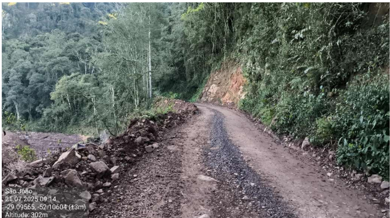
Figura 5: vista geral da via com lera de terra na lateral protegendo a pista. A prefeitura municipal restabeleceu a via para permitir o acesso dos moradores aos serviços essenciais, bem como o transporte de insumos e escoamento da produção leiteira e dos aviários, porém carece de segurança. Data da imagem 21/07/2025. Coordenadas latitude -29.09565° e longitude -52.10604°. Fonte: Progettare Engenharia e Assessoria.
