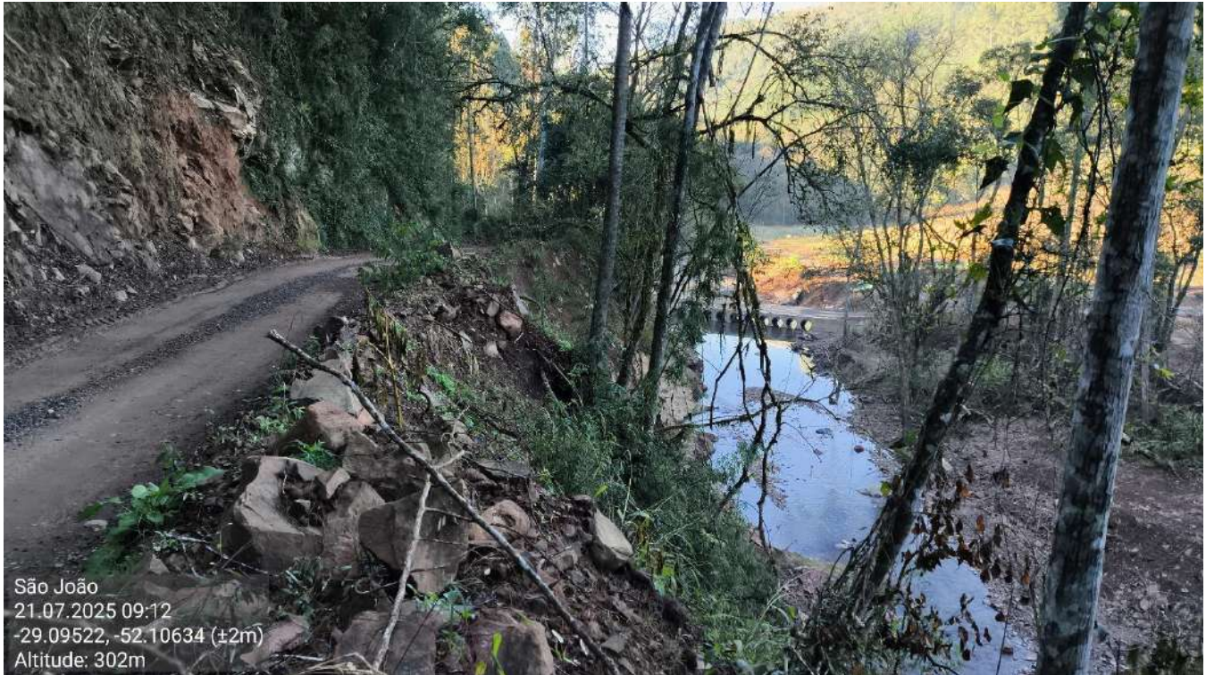
Figura 2: imagem do trecho a ser reconstruído demonstrando a via com sua largura reduzida, os taludes superior e inferior que perderam suas coberturas vegetais após os deslizamentos. A imagem demonstra a inclinação do talude e o material de pouca coesão para ângulos tão altos. Data da imagem: 21/07/2025. Coordenadas latitude -29.09522° e longitude -52.10634°. Fonte: Progettare Engenharia e Assessoria.
