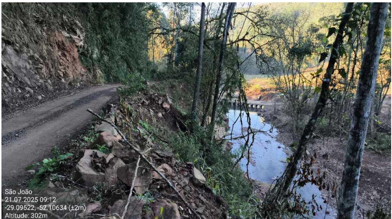
Figura 2: imagem do trecho a ser reconstruído demonstrando a via com sua largura reduzida (atualmente mão única, porém antes era mão dupla), os taludes superior e inferior que perderam suas coberturas vegetais após os deslizamentos. A imagem demonstra a inclinação do talude e o material de pouca coesão para ângulos tão altos. Data da imagem: 21/07/2025. Coordenadas latitude -29.09522^\circ e longitude -52.10634^\circ . Fonte: Progettare Engenharia e Assessoria.
