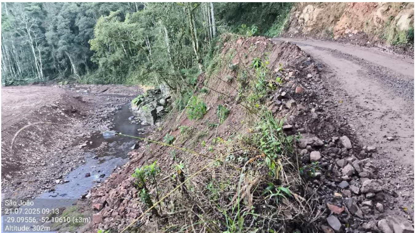
Figura 3: vista de outro ângulo do talude inferior. Proteção da via com lera de terra de forma ineficiente, aumentando o ângulo no topo, de material de aterro. Ainda a falta de drenagem eficiente aumenta o desgaste do maciço, que perde coesão do solo natural, muito perigoso em situações de instabilidade. Também a imagem demonstra a trajetória do Arroio Jacaré com a tangência da correnteza propícia para erodir o pé do talude, provocando o solapamento do mesmo. Data da imagem: 21/07/2025. Coordenadas latitude -29.09556° e longitude -52.10610°. Fonte: Progettare Engenharia e Assessoria.
