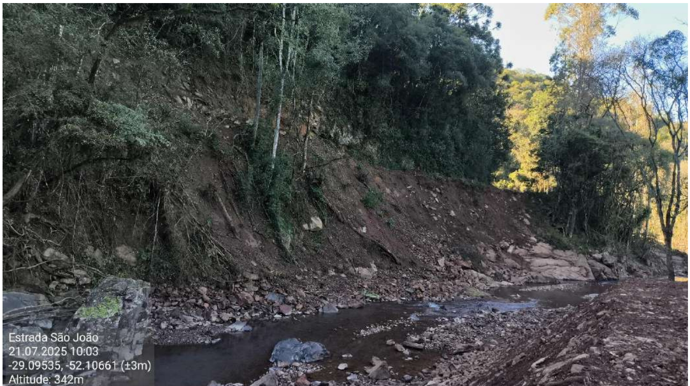
Figura 7: vista do talude inferior e da estrada pela margem oposta do arroio. Percebe-se que os deslizamentos foram circulares, afetando a largura da via. No pé do talude há detritos dos deslizamentos, demonstrando erosão ativa. Data das imagens: 21/07/2025. Coordenadas: latitude -29.09535^\circ e longitude -52.10661^\circ . Fonte Progettare Engenharia e Assessoria.
