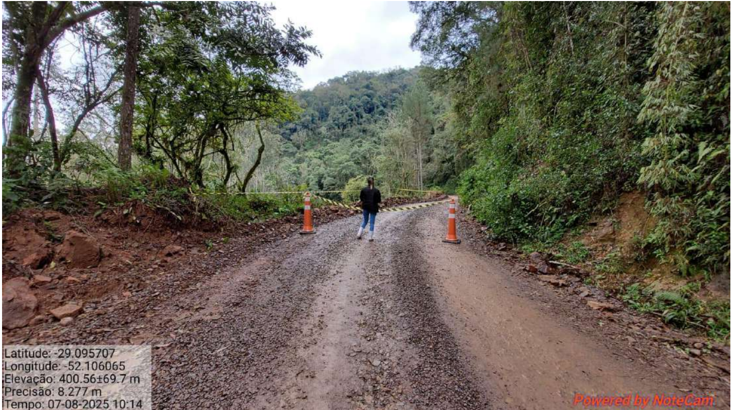
Figura 9: Imagem demonstrando o estreitamento da pista após a erosão do talude inferior. Coordenadas: latitude -29,095707° e longitude -52,106065°. Data da imagem 07/08/2025. Fonte: Município de Relvado.
