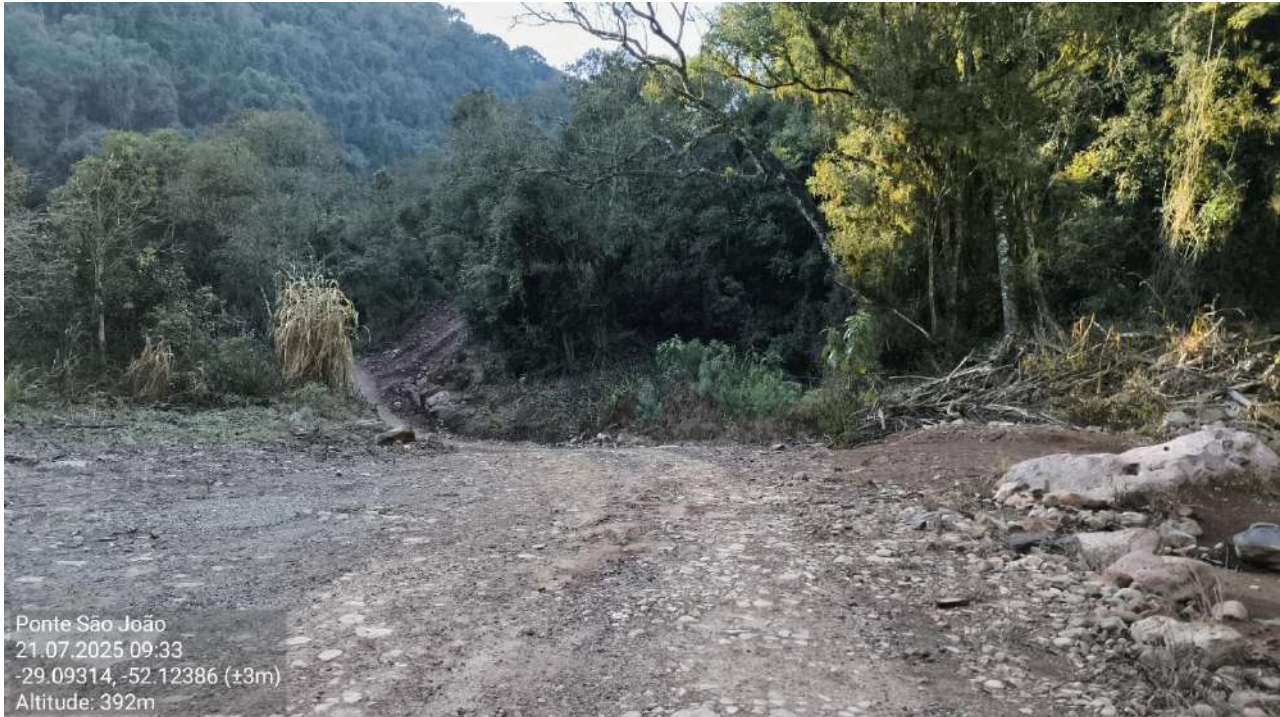
Figura 18: nível do maciço recomposto para acesso a ponte, demonstrando a baixada que precisa ser recomposta. Data da imagem: 21/07/2025. Fonte: Progettare Engenharia e Assessoria. Coordenadas: latitude -29.09314° e longitude -52.12386°.
