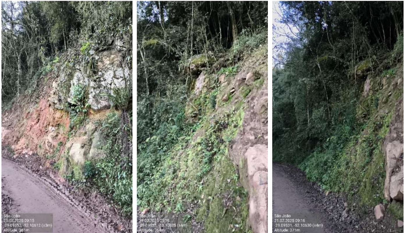
Figura 6: talude superior com rochas fragmentadas e visível ocorrência recente de deslizamento na primeira imagem. Data da imagem 21/07/2025. Coordenadas latitude -29.09552^\circ e longitude -52.10612^\circ ; latitude -29.09533^\circ e longitude -52.10625^\circ ; latitude -29.09531^\circ e longitude -52.10630^\circ . Fonte: Progettare Engenharia e Assessoria.
