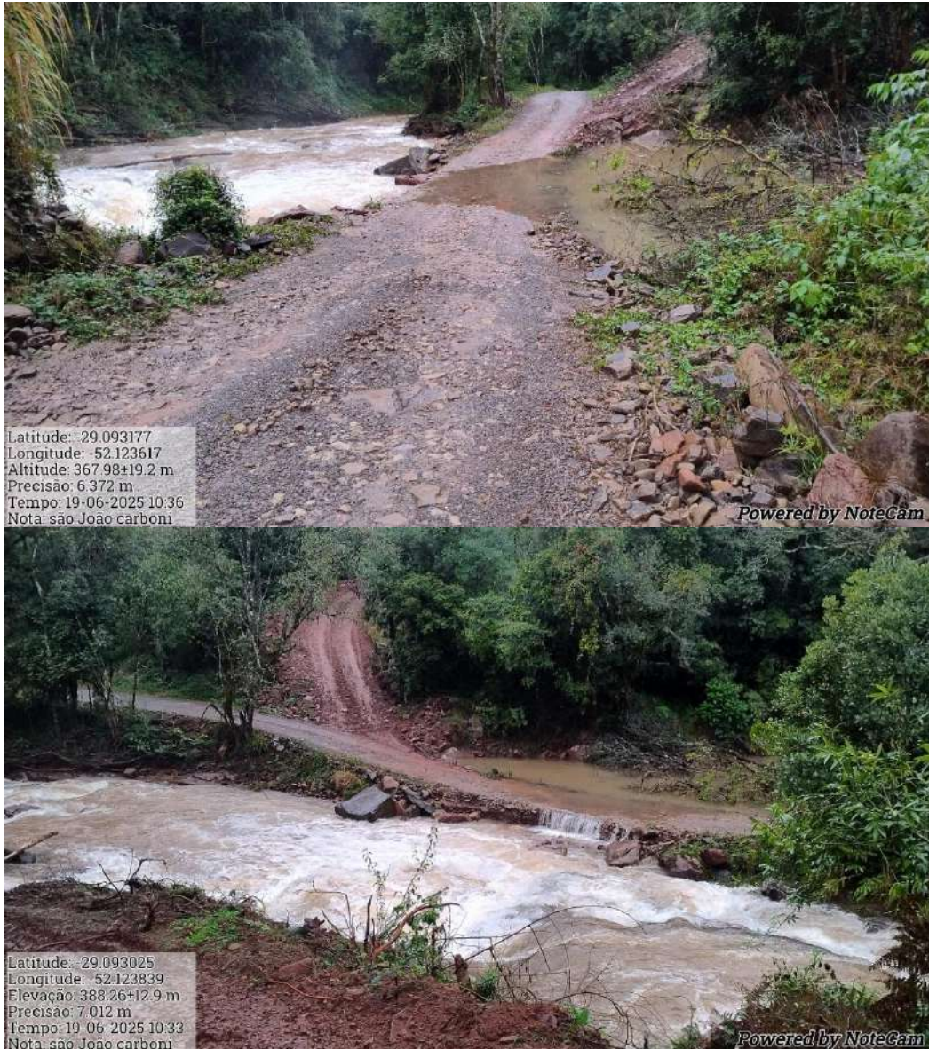
Figura 9: situação da via quando iniciou o período chuvoso em junho de 2025. É necessária a execução de uma linha de bueiros de \varnothing 1000 mm para dar o escoamento da água pluvial que se acumula à montante, no espaço erodido, e elevar o nível da via para que fique em cota superior à do leito do arroio. Data da imagem: 19/06/2025. Fonte: Prefeitura Municipal de Relvado. Coordenadas: latitude -29.093177° e longitude -52.123617°; latitude -29.093025° e longitude -52.123839°.
