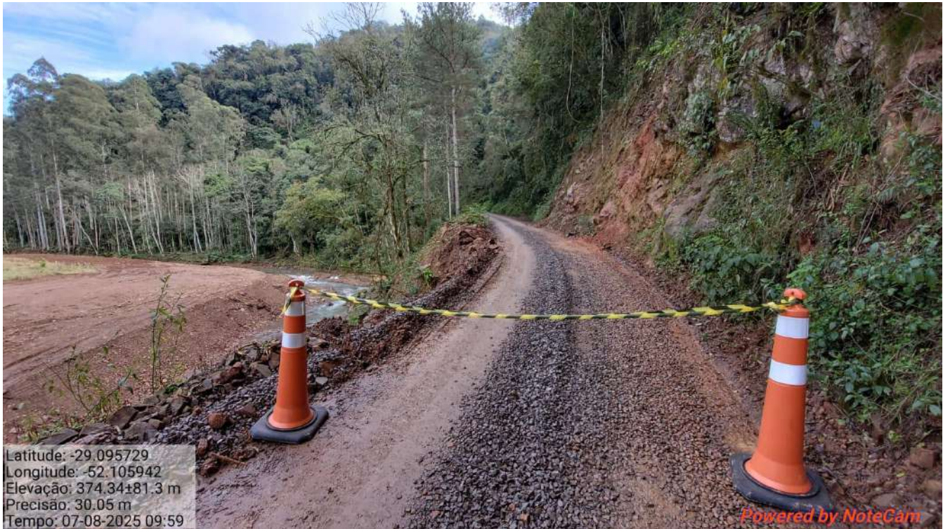
Figura 5: vista geral da via com lera de terra na lateral protegendo a pista. A prefeitura municipal restabeleceu a via para permitir o acesso dos moradores aos serviços essenciais, bem como o transporte de insumos e escoamento da produção leiteira e dos aviários, porém carece de segurança. Data da imagem 07/08/2025. Coordenadas latitude -29.095729^\circ e longitude -52.105942^\circ . Fonte: Município de Relvado.
