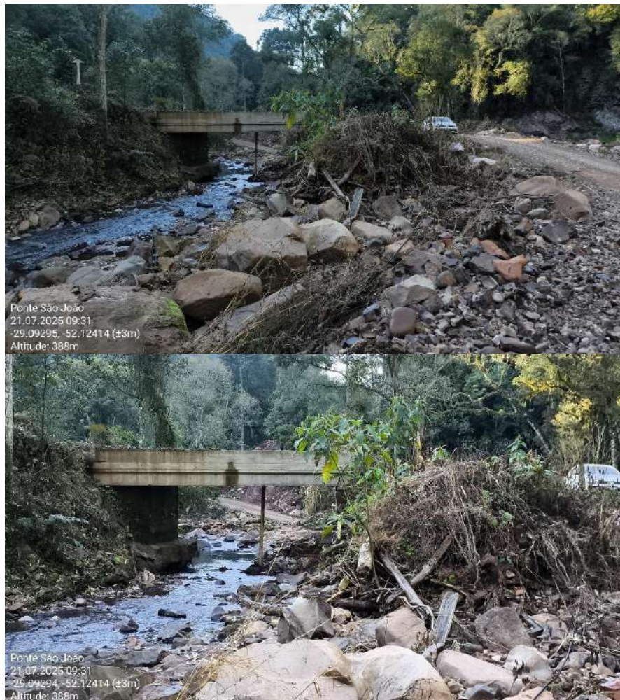
Figura 15: imagem demonstrando o atual nível da via (visível nas imagens abaixo do tabuleiro da ponte), bem como a diferença de cota entre o nível de entrada da ponte e a via. Ainda demonstra a necessidade de encaminhar o leito do arroio de forma evitar a erosão nas saídas de curva do arroio, bem como a sustentação da reconstrução do aterro da estrada. Data da imagem: 21/07/2025. Fonte: Progettare Engenharia e Assessoria. Coordenadas: latitude -29.09295° e longitude -52.12414°; latitude -29.09294° e longitude -52.12414°.
