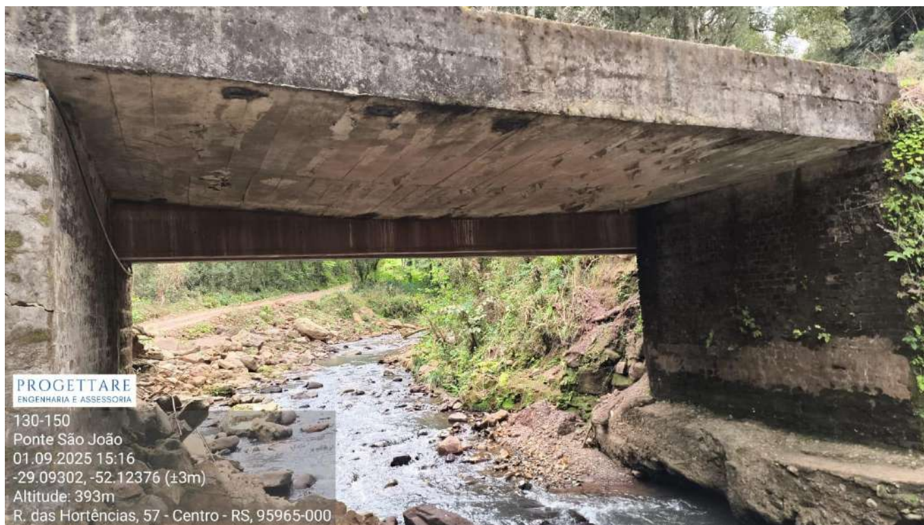
Figura 3: o tabuleiro da ponte apresenta flecha acentuada com risco de colapso iminente . Na cabeceira esquerda observa-se o preenchimento do espaço solapado por depósitos de aluvião/seixos rolados , material de baixa resistência e incapaz de garantir a estabilidade das fundações frente às cargas transmitidas pela superestrutura. Evidenciam-se também rachaduras significativas nas alas , comprometendo a integridade estrutural do conjunto. Coordenadas: latitude -29.09302° e longitude -52.12376°. Data da imagem: 01/09/2025. Fonte: Progettare Engenharia e Assessoria.
