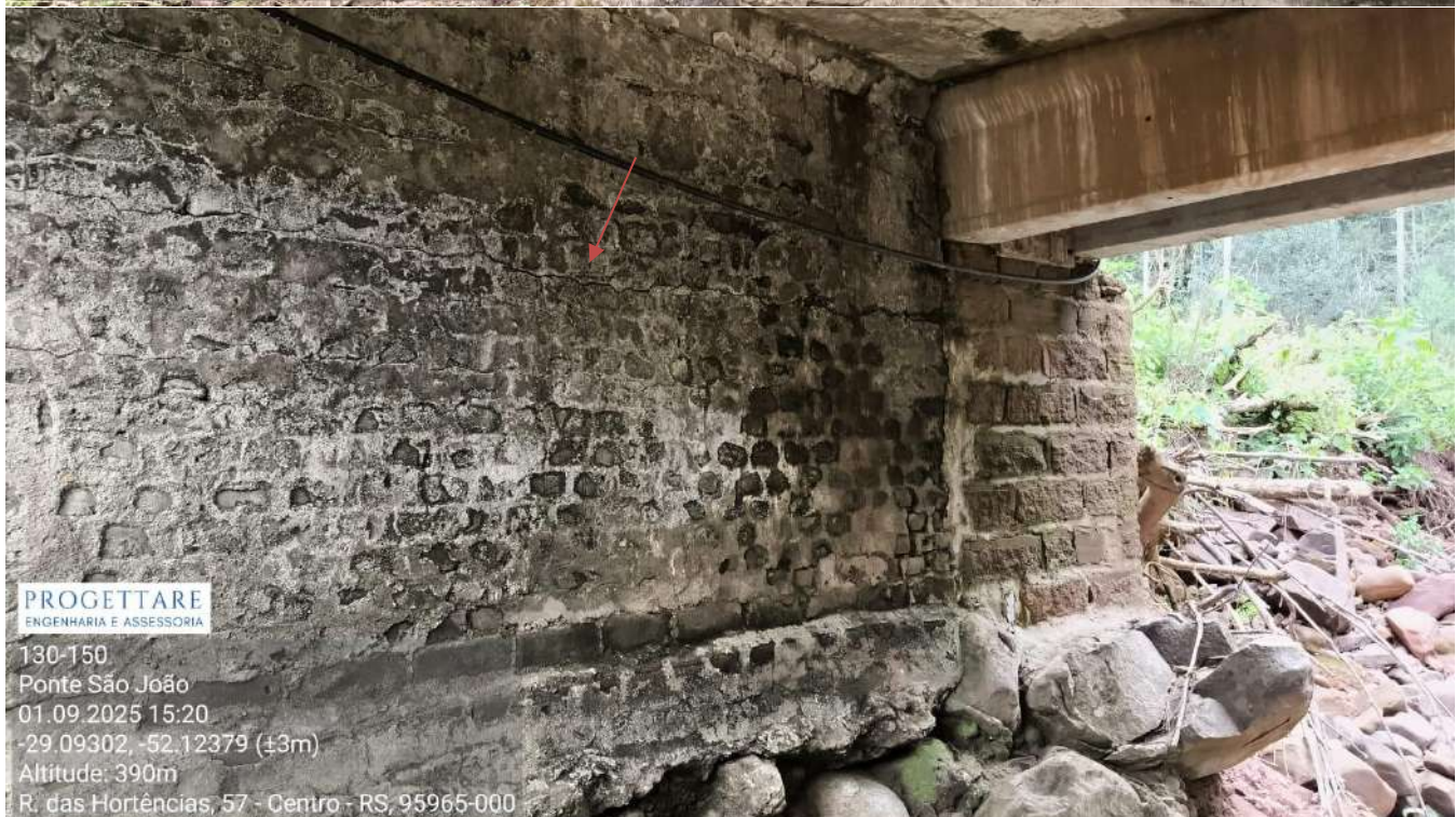
Figuras 11 e 12: evidenciam-se sinais de torsionamento do tabuleiro e cabeceiras , decorrentes da ação assimétrica da correnteza e do impacto de detritos durante a cheia de junho de 2025. O esforço torcional gerou recalque diferencial da laje e trincas diagonais nas cabeceiras , caracterizando perda da estabilidade estrutural e risco iminente de colapso. Data das imagens: 01/09/2025. Coordenadas: latitude -29.09301° e longitude -52.12379; latitude -29.09302 e longitude -52.12379°. Fonte Progettare Engenharia e Assessoria.
