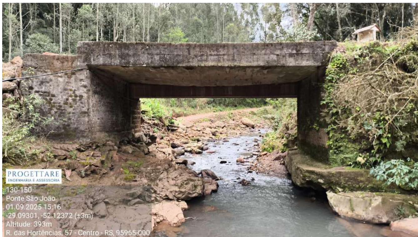
Figura 2: vista lateral à jusante da ponte sobre o Arroio Jacaré, onde se evidencia flecha acentuada da laje do tabuleiro , indicando recalque diferencial e descontinuidade estrutural na borda a montante. Observam-se ainda rachaduras significativas na cortina de ala esquerda e processo de solapamento da fundação na ala direita , comprometendo a estabilidade global da estrutura. A condição atual caracteriza risco iminente de colapso . Data da imagem: 01/09/2025. Coordenadas latitude -29.09301° e longitude -52.12372°. Fonte: Progettare Engenharia e Assessoria.
