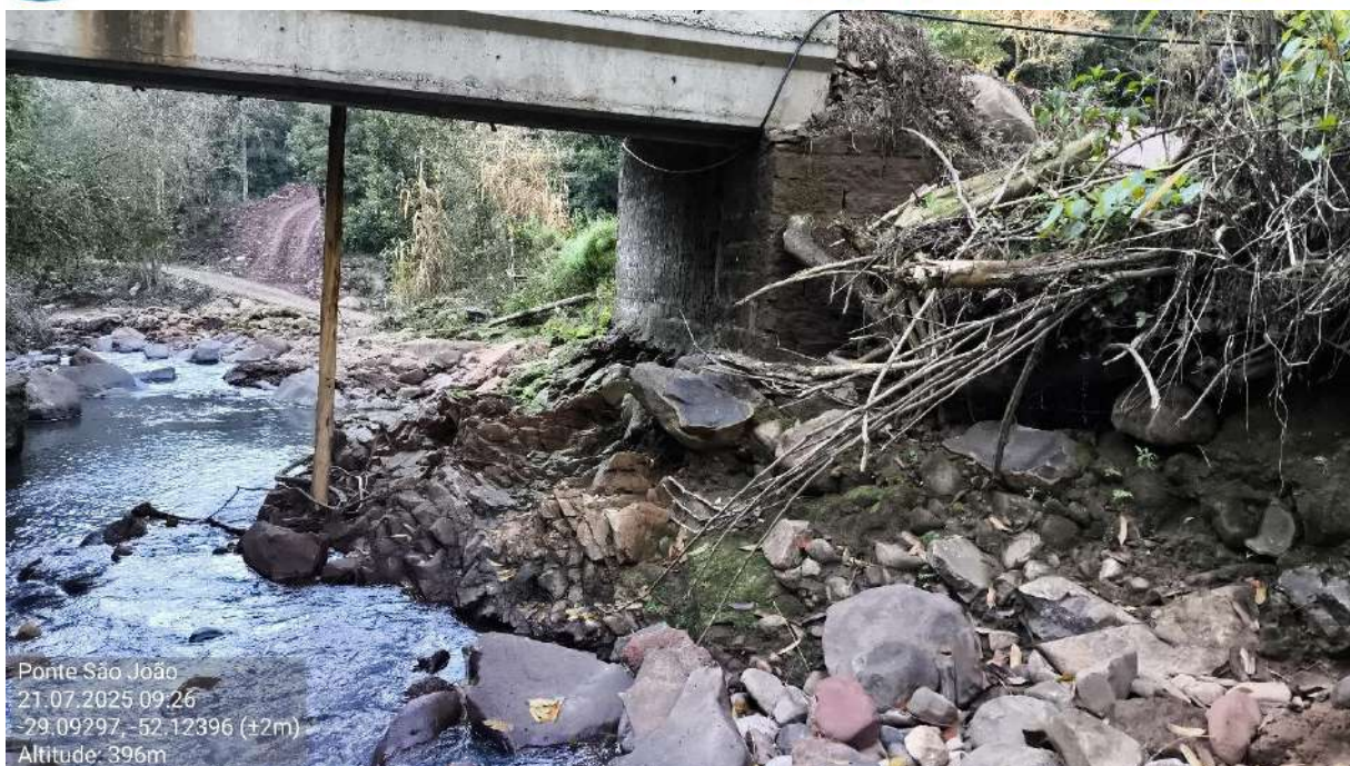
Figura 9 Entorno da ponte com detritos (galhos e árvores arrastados pela correnteza do arroio durante o evento climático. Data das imagens: 21/07/2025. Coordenadas: latitude -29.09297° e longitude -52.12396. Fonte Progettare Engenharia e Assessoria.
