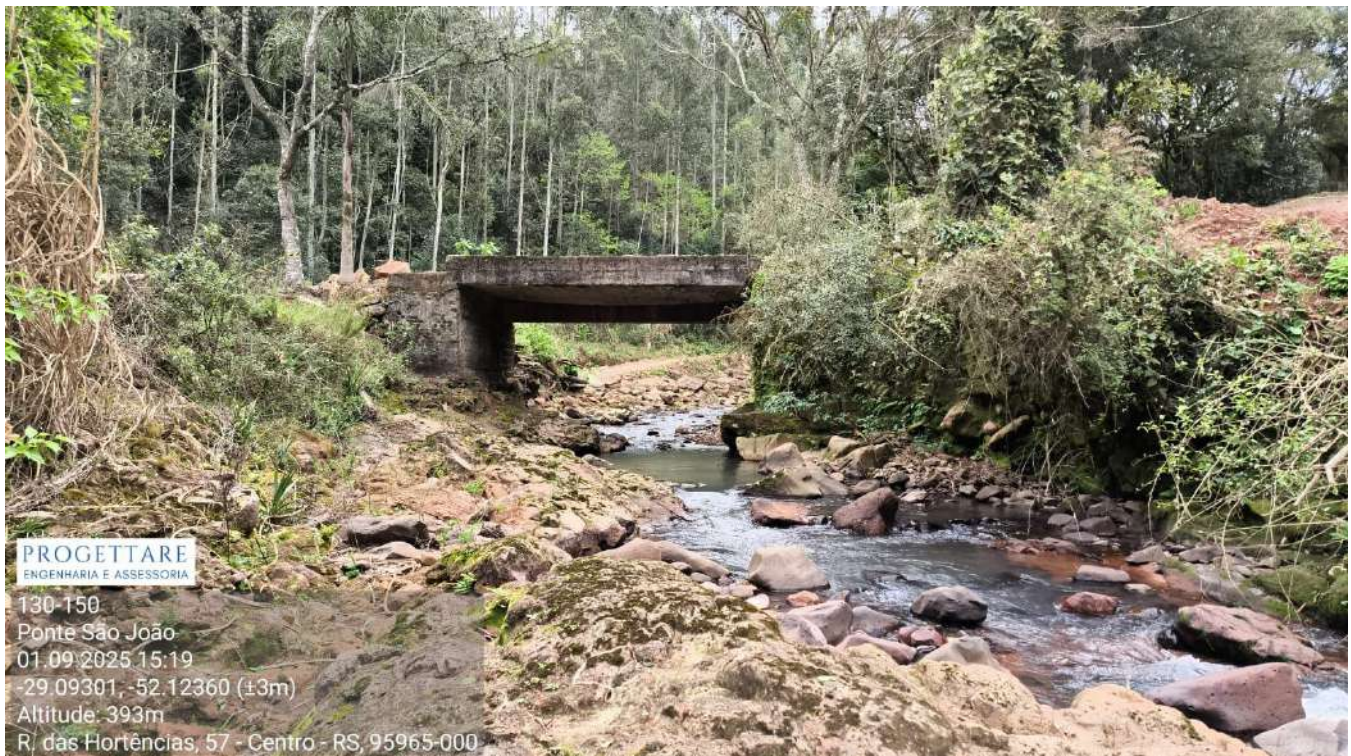
Figura 8: vista geral da ponte sobre o Arroio Jacaré, evidenciando os efeitos da cheia de junho de 2025 no curso do arroio, que sofreu alteração e deslocamento de margens , intensificando processos erosivos junto às fundações. Observa-se ainda a flecha da laje do tabuleiro e trecho da sapata sem sustentação, resultantes da ação das águas e do arraste de blocos e detritos. Tais condições reforçam a magnitude do evento climático e o consequente o comprometimento estrutural da ponte, levando à necessidade de interdição. Data da imagem 01/09/2025. Coordenadas latitude -29.09301° e longitude -52.12360°. Fonte: Progettare Engenharia e Assessoria.
