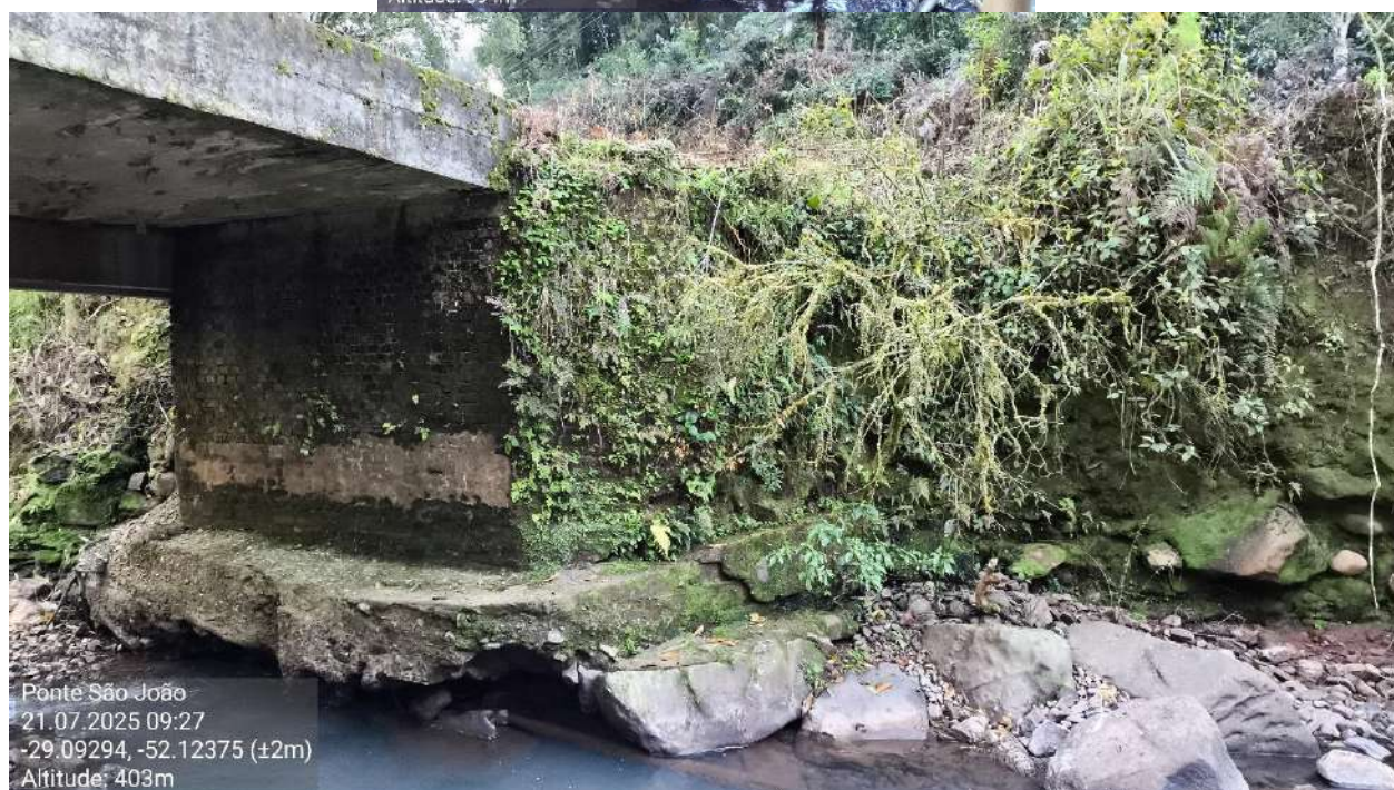
Figura 7 Cabeceira da ponte perdeu a sustentação das fundações, o que reduz sua capacidade de carga, agravando o risco de colapso. Pode-se visualizar trinca na lateral da sapata, reforçando o iminente colapso da estrutura. Eflorescências na alvenaria das cabeceiras. Data das imagens: 21/07/2025. Coordenadas: latitude -29.09305° e longitude -52.12382; latitude -29.09294 e longitude -52.12375°. Fonte Progettare Engenharia e Assessoria.
