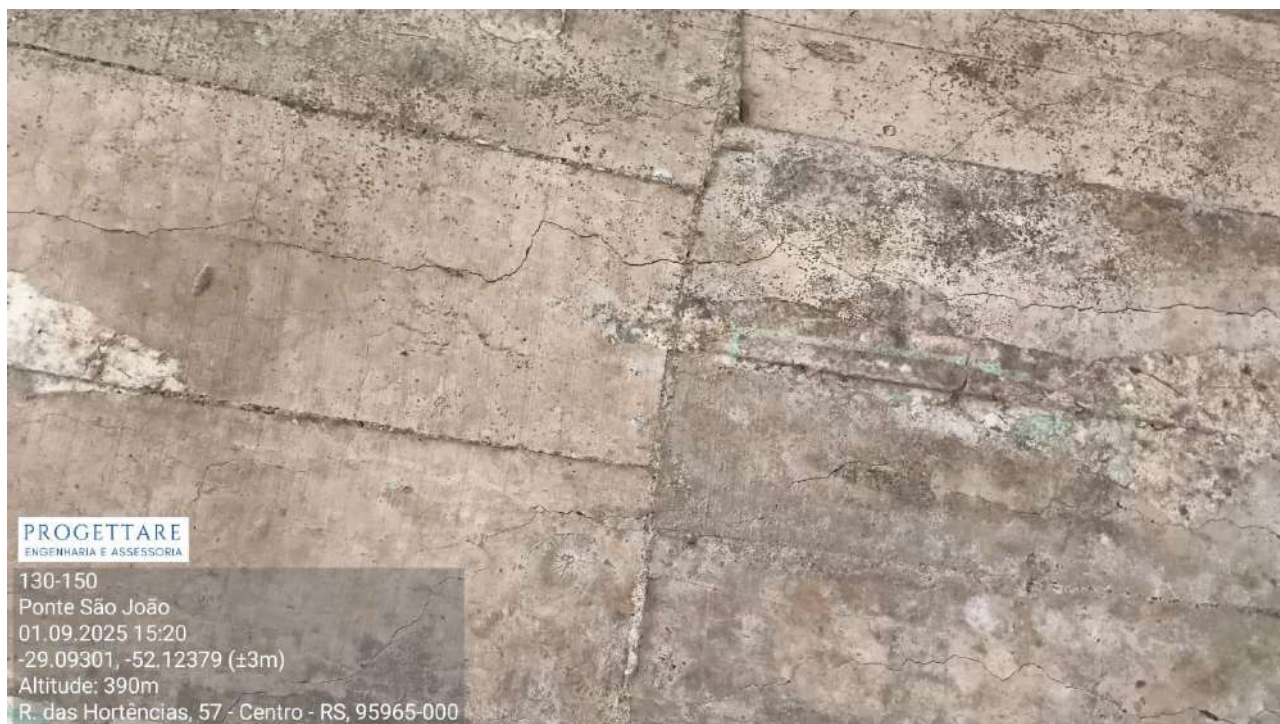
Figuras 5 e 6: observam-se fissuras generalizadas na face inferior da laje do tabuleiro , resultantes do recalque diferencial e da flexão excessiva do concreto armado . As aberturas seguem padrões longitudinais e transversais, caracterizando perda de continuidade estrutural e comprometimento da capacidade resistente da seção. Essa condição reforça o quadro de instabilidade já identificado, indicando risco de evolução para ruptura frágil caso as cargas atuantes se mantenham ou aumentem. Coordenadas: latitude -29.09301° e longitude -52.12379°. Fonte: Progettare Engenharia e Assessoria.
