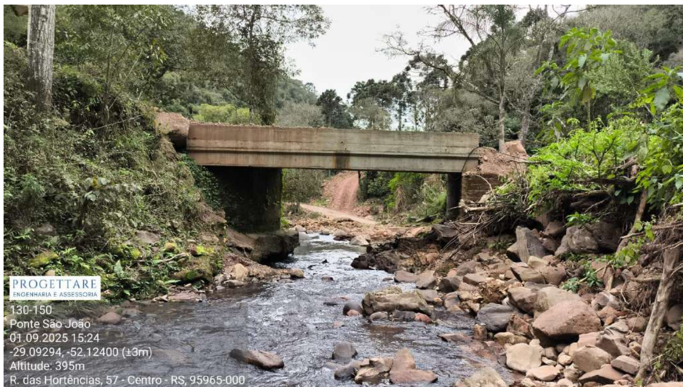
Figura 13: vista à montante da ponte, evidenciando a erosão da vala formada pela força da correnteza, bem como a presença de galhos, troncos e detritos arrastados durante a cheia de junho de 2025. Esses registros demonstram a magnitude do evento climático e sua contribuição direta para o solapamento das fundações e o comprometimento estrutural da ponte. Data das imagens: 01/09/2025. Coordenadas: latitude -29.09294° e longitude -52.12400°. Fonte Progettare Engenharia e Assessoria.
