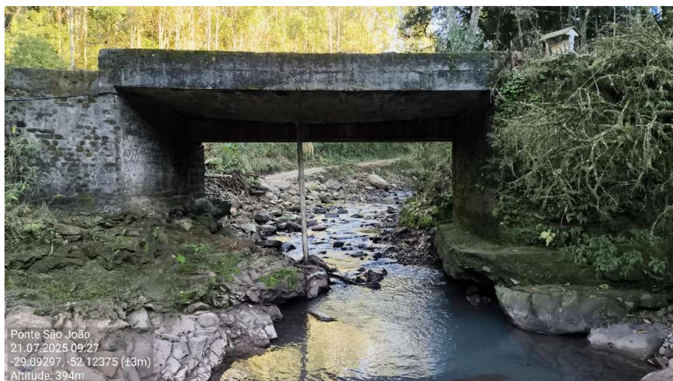
Figura 2 imagem lateral da ponte e cabeceiras. É possível visualizar trinca transversal atravessando a cabeceira esquerda, bem como a flecha gerada no tabuleiro cedido, o qual está escorado para evitar colapso. Além disso, na cabeceira direita a sapata perdeu a sustentação, estando parcialmente sem nenhum apoio. Data da imagem: 21/07/2025. Coordenadas latitude -29.09297° e longitude -52.12375°. Fonte: Progettare Engenharia e Assessoria
