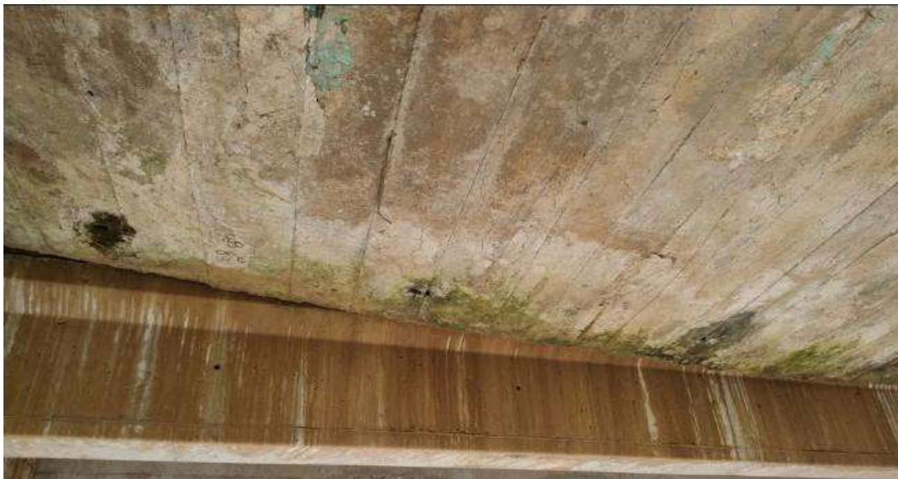
Figura 3 Tabuleiro da ponte cedeu e apresenta uma flecha que indica o colapso iminente. Fonte: Prefeitura Municipal de Relvado. Data da imagem: 17/07/2025.
