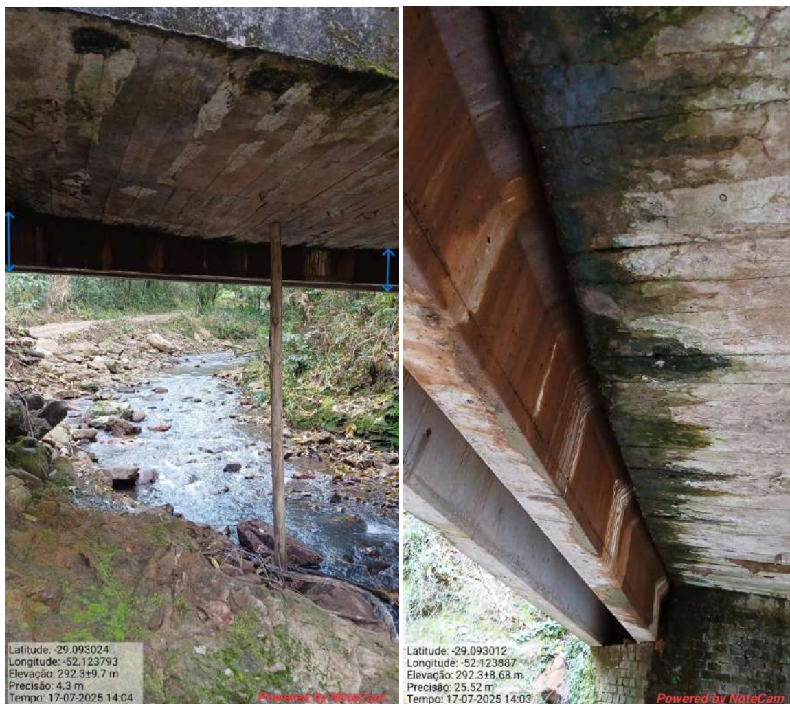
Figura 4 Comparativo de flecha entre a extremidade da ponte em sua parte central. Além disso são visíveis patologias de infiltração. Data da imagem 17/07/2025. Coordenadas latitude -29.093024° e longitude -52.123793°. Fonte: Prefeitura Municipal de Relvado.
