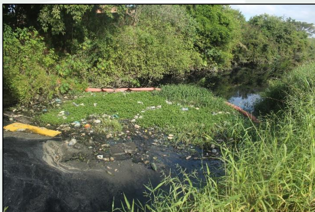
Figura 7 – Registro de poluição e contenção no canal de macrodrenagem.
