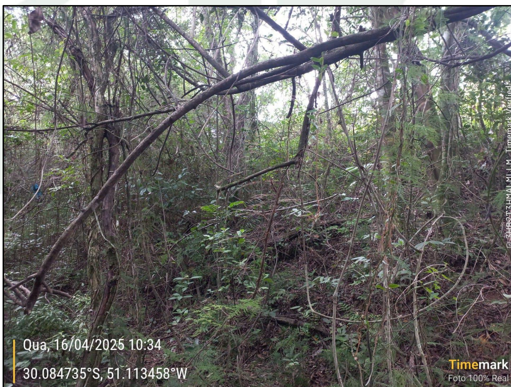
Foto 2 – Vegetação sobre o talude da barragem
