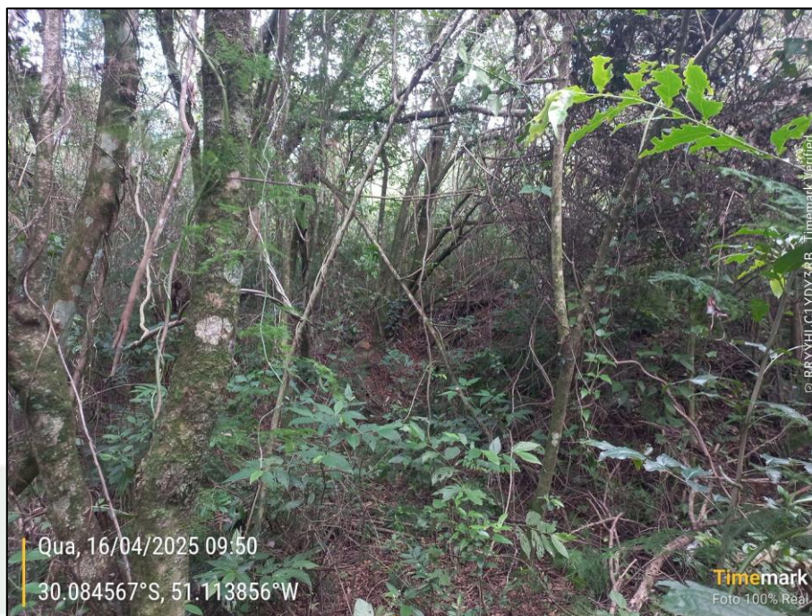
Foto 8- Vegetação sobre o talude da barragem
