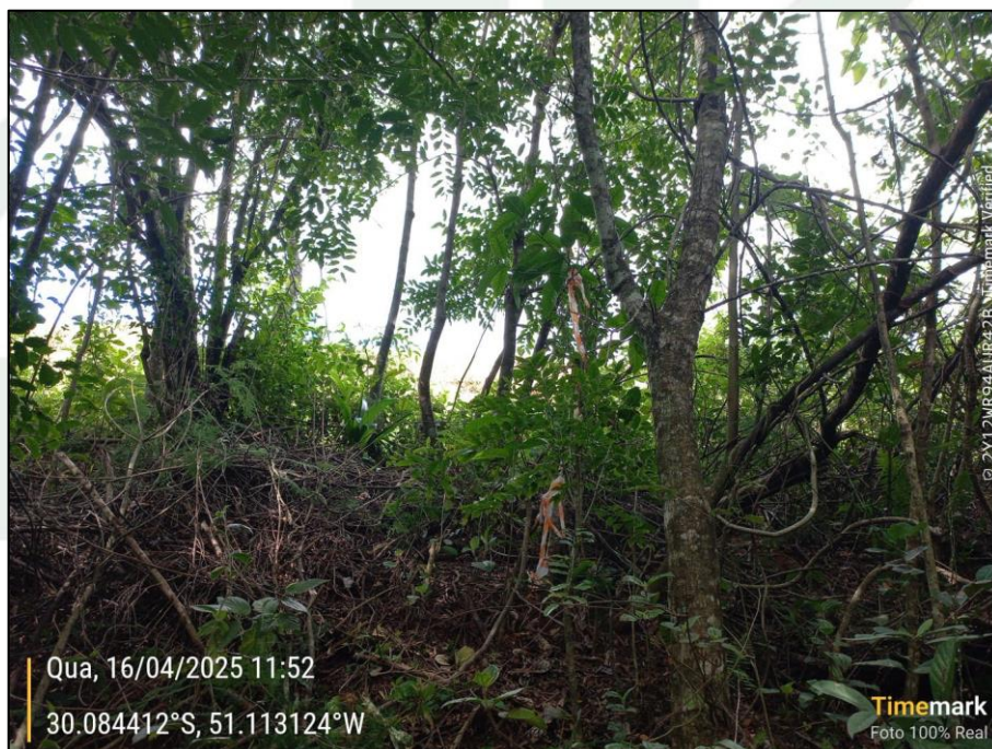
Foto 11 – Vegetação ocorrente sobre o talude a jusante
