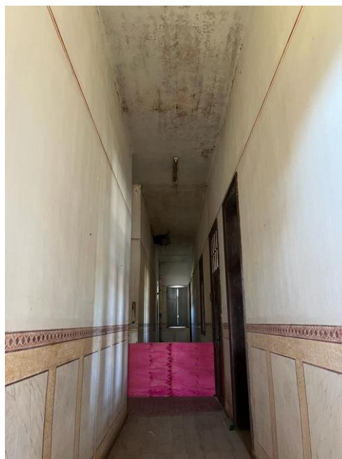
Foto 18 – Interno – Forros da circulação - estuque Foto: Leilah Schäedler
