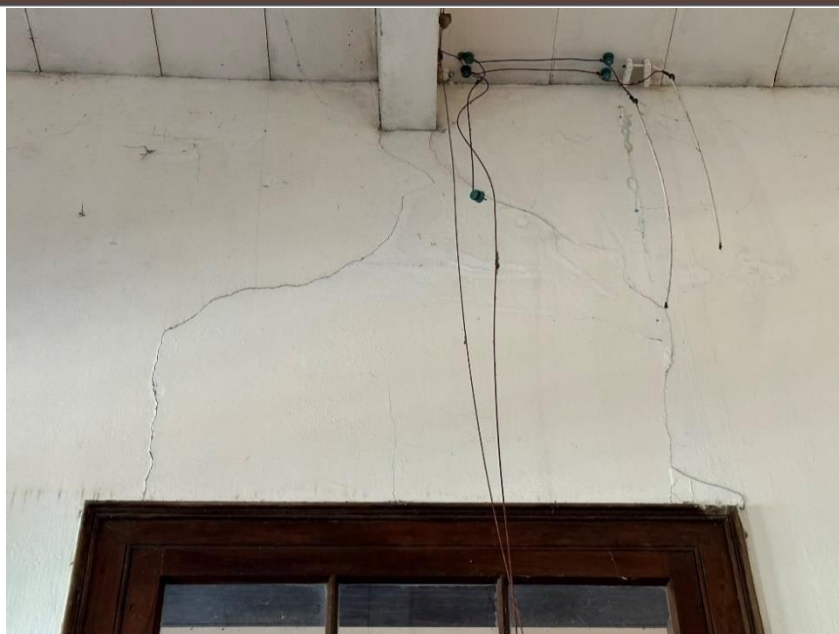
Foto 23 – Interno – Rachadura sobre a porta de acesso da sala 11 Foto: Leilah Schäedler
