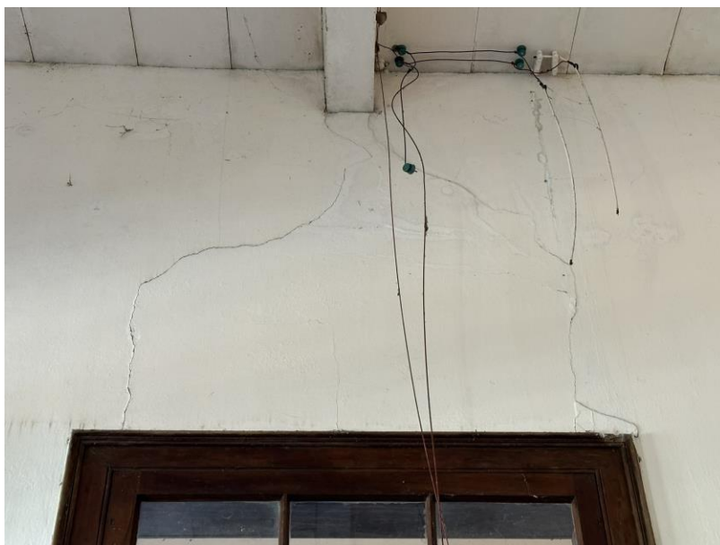
Foto 45 – Interno – Instalações elétricas Foto: Leilah Schäedler
