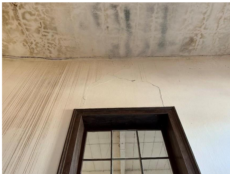
Foto 21 – Interno – Rachadura sobre a porta de acesso da sala 03 Foto: Leilah Schäedler
