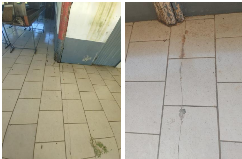
Piso que deverá ser substituído em alguns trechos
