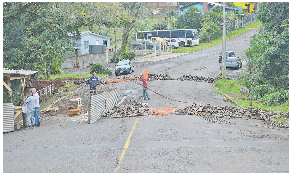
Ponte do bairro Navegantes, está interditada desde o ciclone em junho
