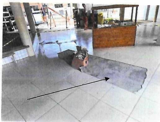
Figura 2 - Piso do Saguão com deslocamento
