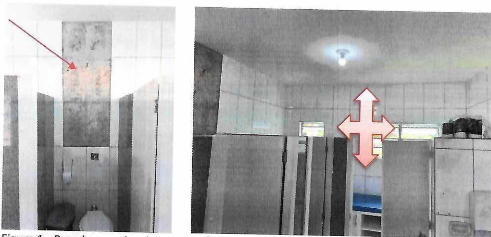
Figura 1 - Parede com deslocamento (esquerda) e parede lateral (direita) comprometida, próxima as janelas
