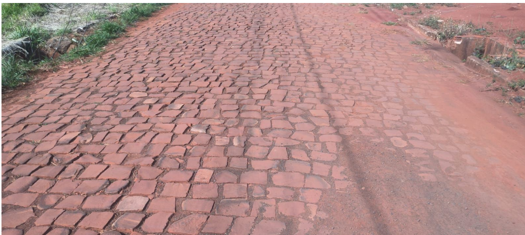
Figura 5 – Detalhe da superfície, evidenciando juntas abertas e irregularidades localizadas.
