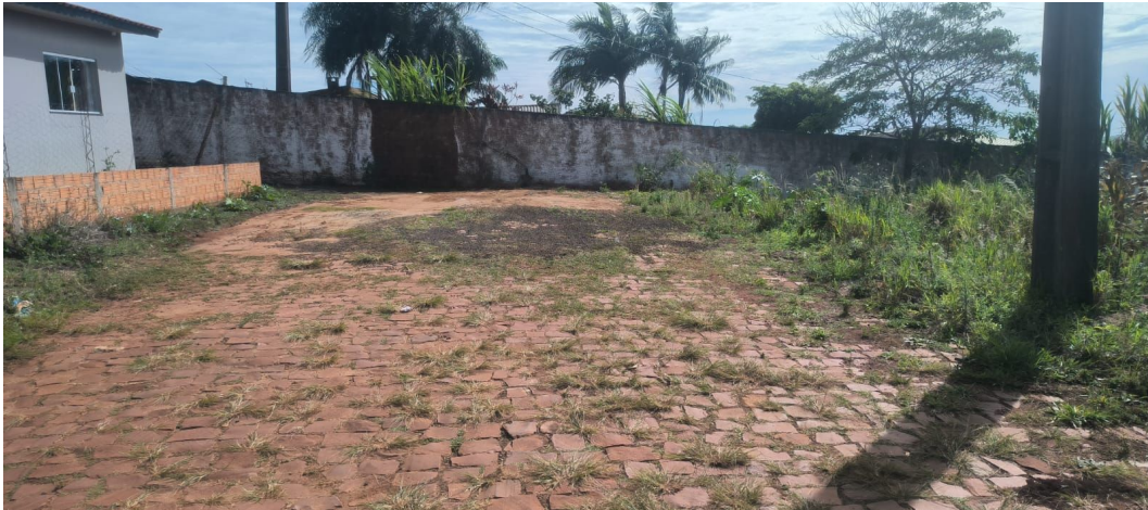
Figura 7 – Vista de área terminal ou de concordância, com vegetação e solo sobre parte do calçamento.
