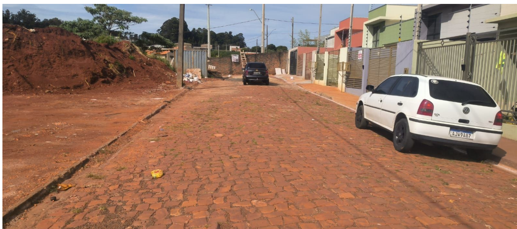
Figura 2 – Vista do subtrecho, com irregularidades superficiais e presença de material fino sobre o calçamento.
