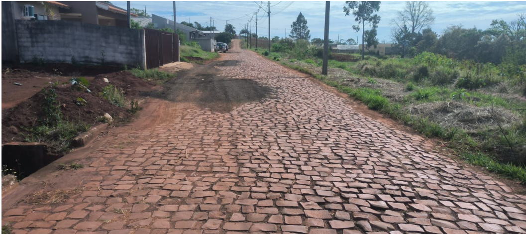
Figura 4 – Vista longitudinal com remendo granular localizado e variações de acomodação das pedras.
