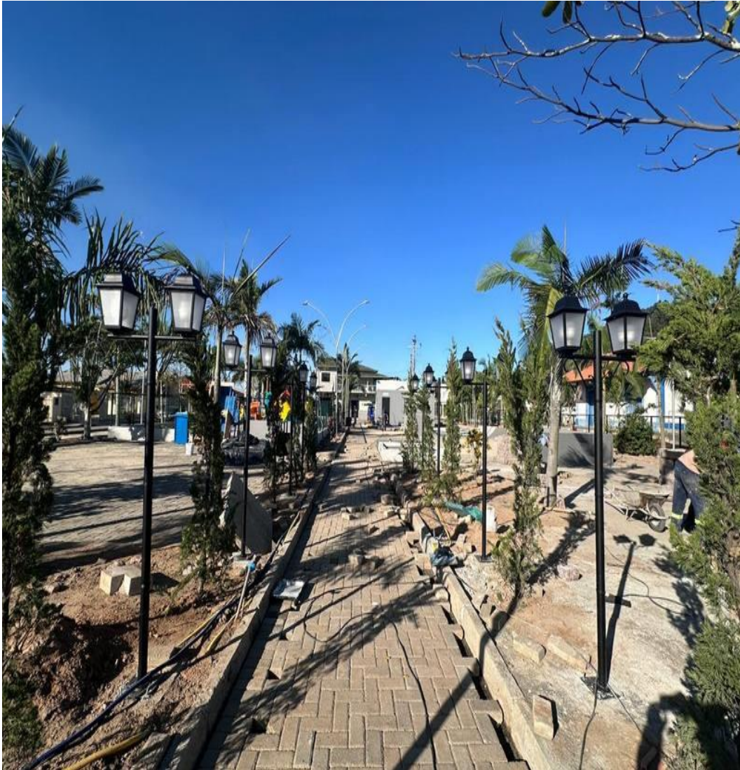
Fotografia 06 — Passeio, mobiliário e iluminação da Praça Pedro Bernardino da Silva, com indicação do estado geral de conservação do espaço público no momento do registro fotográfico.
