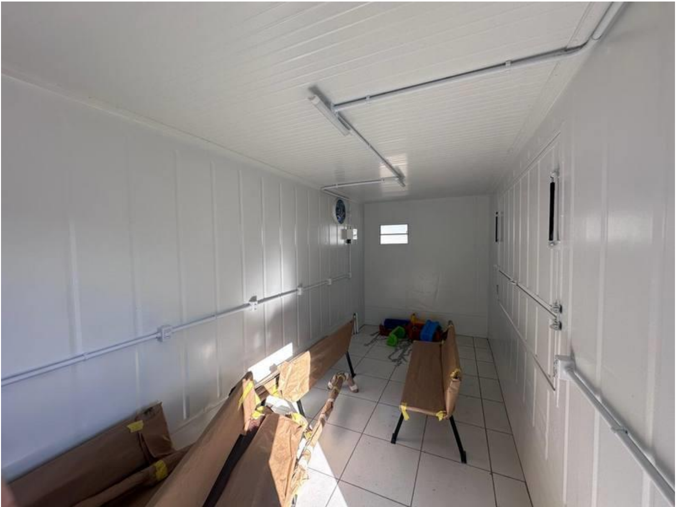
Fotografia 03 — Box 01/container: vista interna, com identificação da área de conveniência (12,99 m 2 ), instalações elétricas, esquadrias, janela de ventilação e infraestrutura existente.
