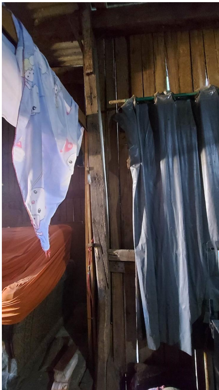
Figura 3: rachadura pilar de madeira
