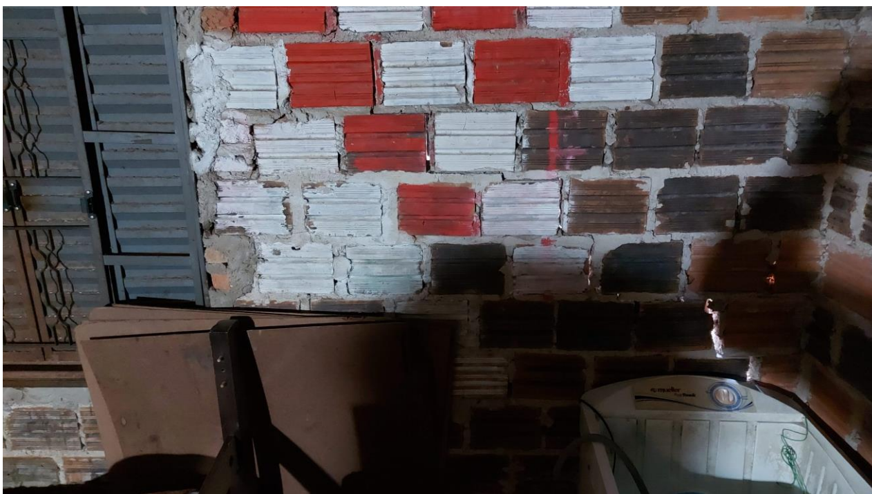
Figura 2: rachaduras parede de alvenaria dos fundos
