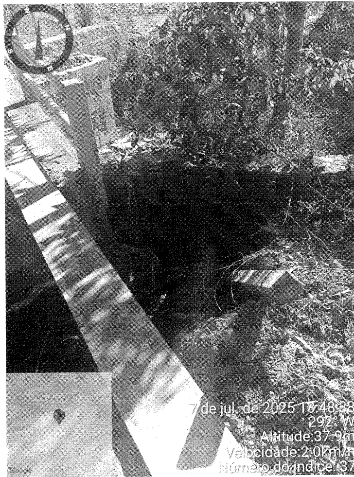
Imagem 10: Comprometimento estrutural – Cabeceira afastada do reforço estrutural por conta do desmoronamento de terra, relato realizado em 07 de julho de 2025.
