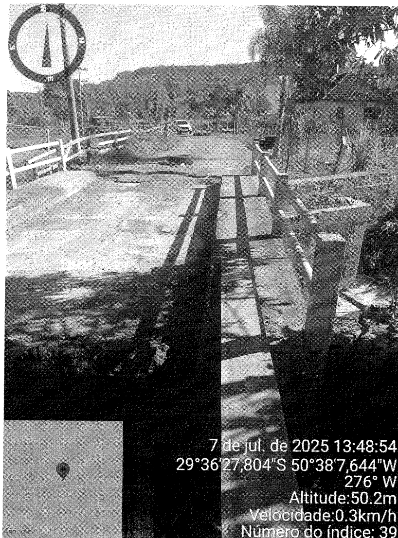
Imagem 11: Cabeceira desmoronando, comprometendo a estrutura. Relato realizado em 07 de julho de 2025
