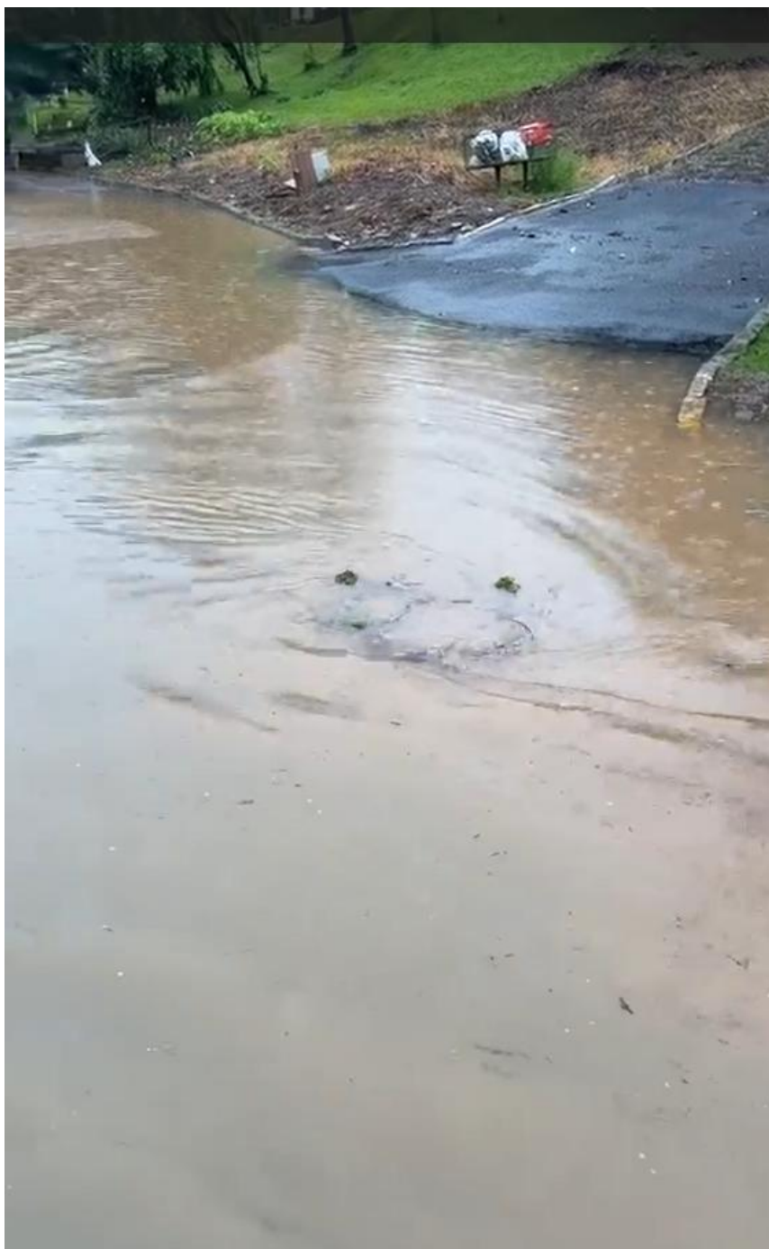
Imagem 06 – Boca de lobo entupida, com algas
